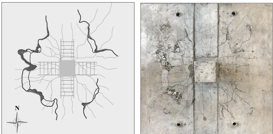
Figura 4.4 – Mapa de fissuração da laje TA-05
