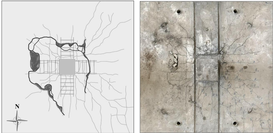
Figura 4.3 – Mapa de fissuração da laje CA-05
