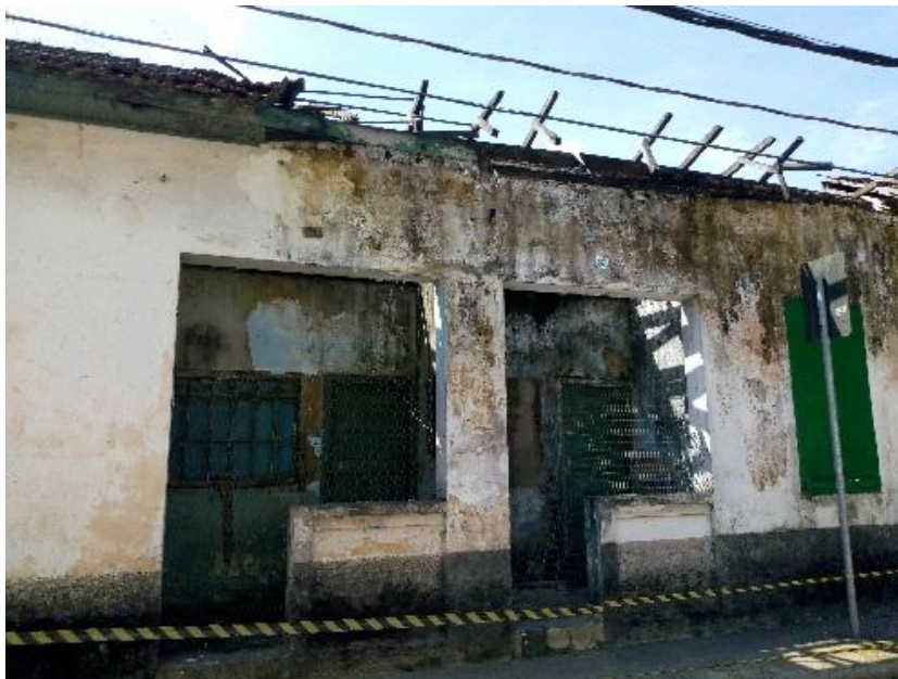
Figura 11: Casa com conservação arruinada pela ação do tempo
