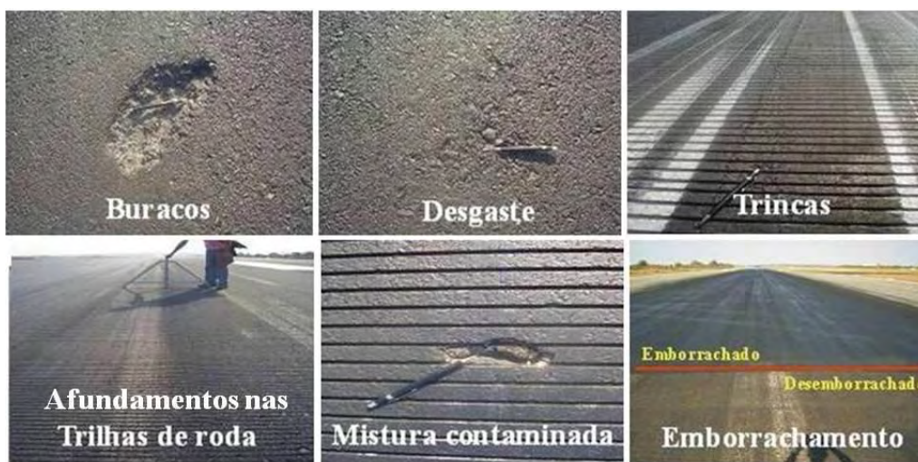
Figura 2.9 - Defeitos encontrados na pista antiga do AIB (Silva, 2008)
