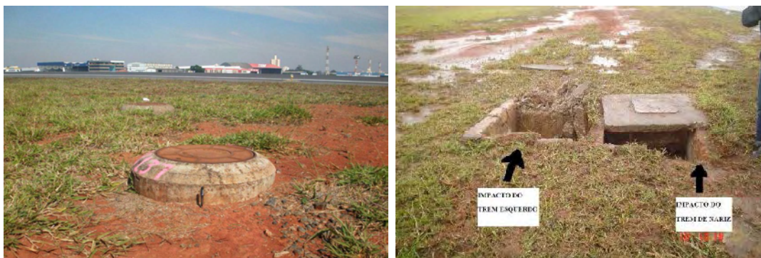
Figura 2.6 - Caixa de inspeção com cerca de 22 cm de altura na lateral da Pista 17R/35L (CENIPA, 2008).
