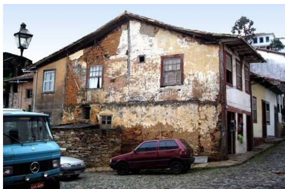
Figura 2 – Mostra uma edificação que necessita estabilização e consolidação de sua estrutura
