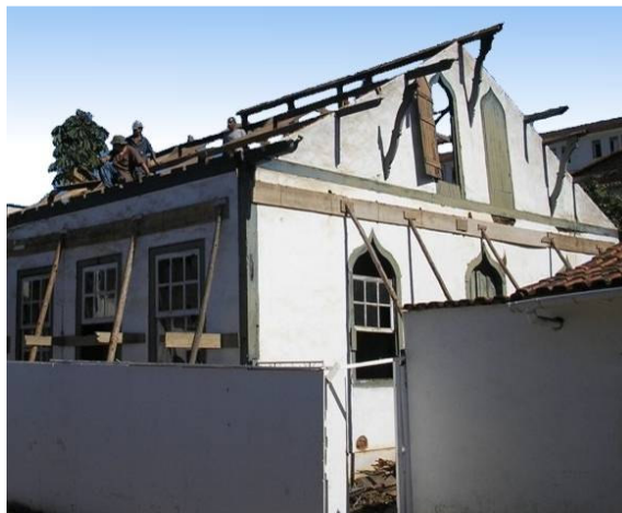
Figura 1 – Mostra uma edificação em que a fachada e a cobertura estão em recuperação.
