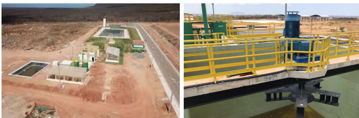
Figura 3 - Instalações e equipamentos da Central de Tratamento de Resíduos construída pelo Governo do Estado e cedida ao Consórcio CGIRS-RMS, em Sobral-CE
