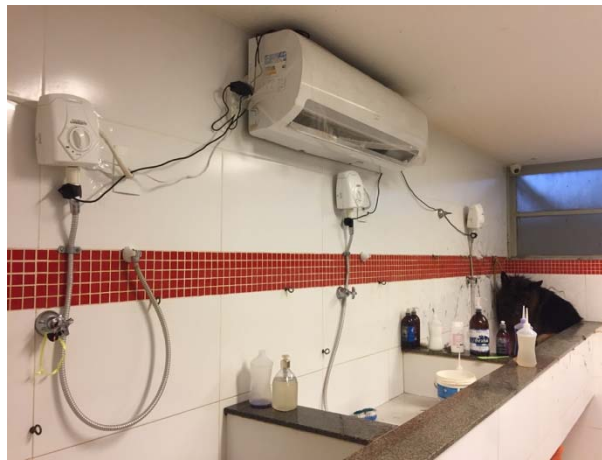
Figura 7 - Medidores de fluxo instalados em chuveiros de pet shop.
