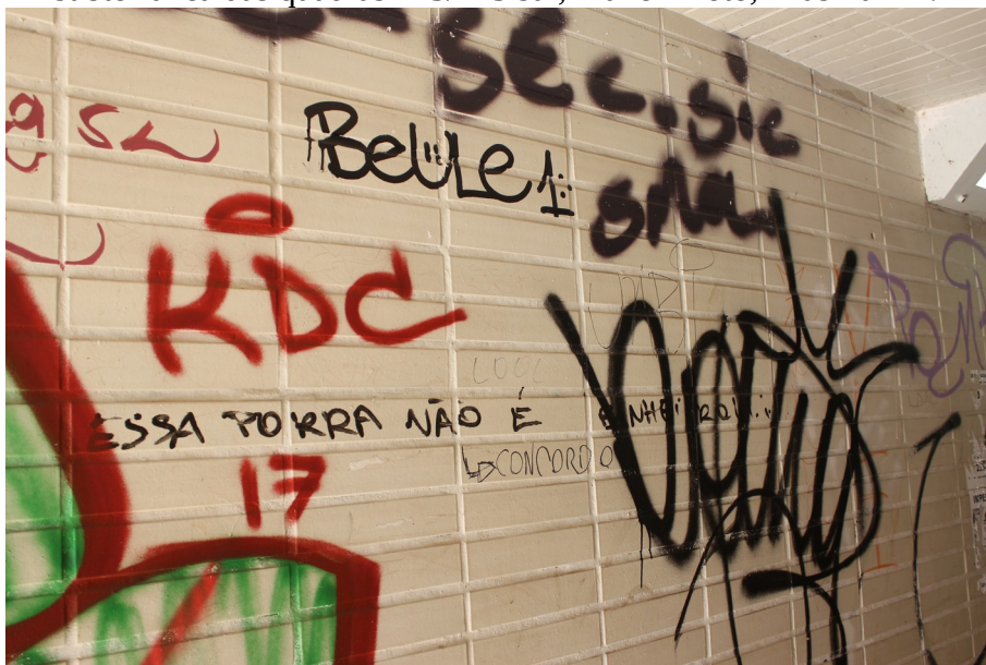
Figura 12 - Frase pixada: “essa porra não é banheiro”. Passagem subterrânea das quadras 113/213 sul, Plano-Piloto, Brasília-DF.
