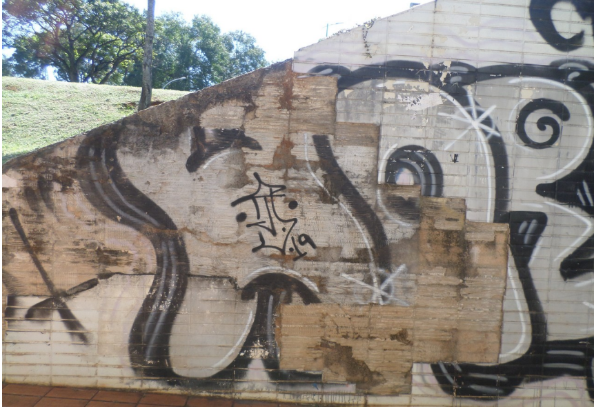
Figura 14 - Tentativa de revitalizar paredes da passagem subterrânea das quadras 103/203 norte, Plano Piloto, Brasília-DF.
