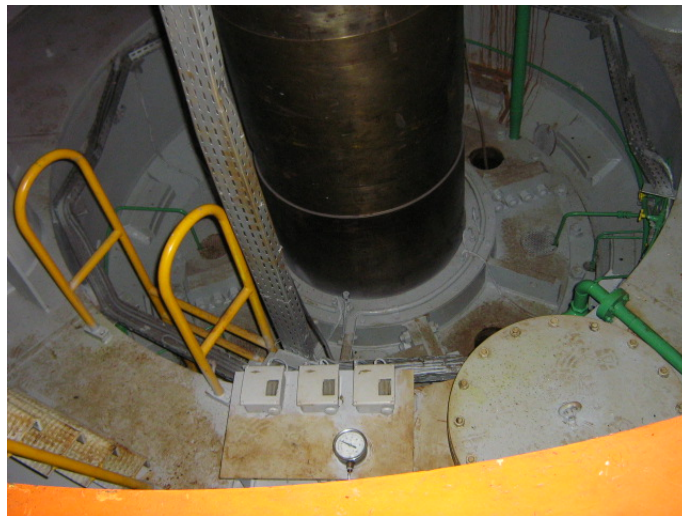
Figura 6.3: Tampa inferior da turbina Kaplan.
