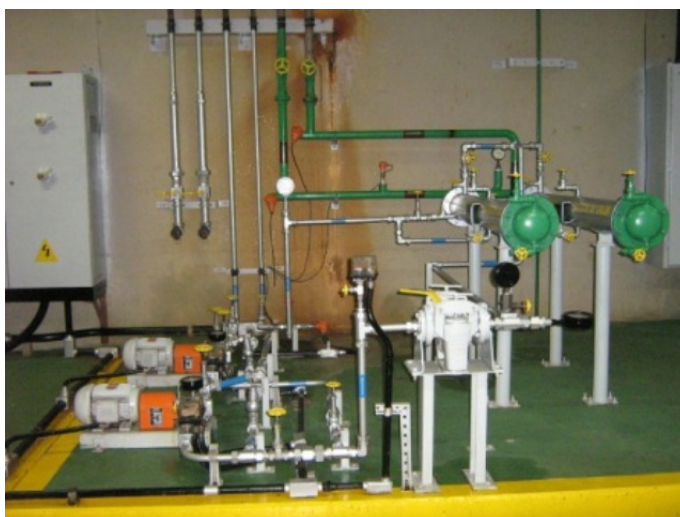
Figura 6.6: Trocadores de calor – Sistema de resfriamento.
