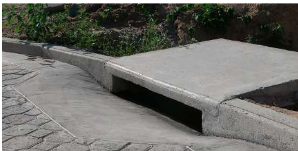
Figura 71 - Boca de lobo para coleta da água pluvial. Fonte: http://smartcitylaguna.com.br/galeria/
