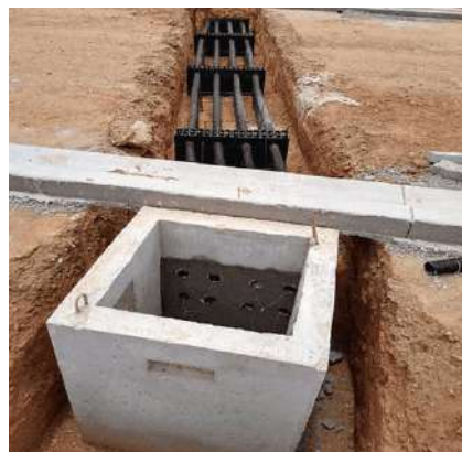
Figura 73 - Rede subterrânea de energia Fonte: http://smartcitylaguna.com.br/galeria/
