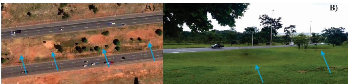
Figura 4: Sequência de falsas dolinas associadas a rodovia indicadas por setas azuis (sistema contra enchentes). A) imagem histórica Google que resalta depressões em época seca; B) depressões em época chuvosa, sem contraste da vegetação (foto do autor).
