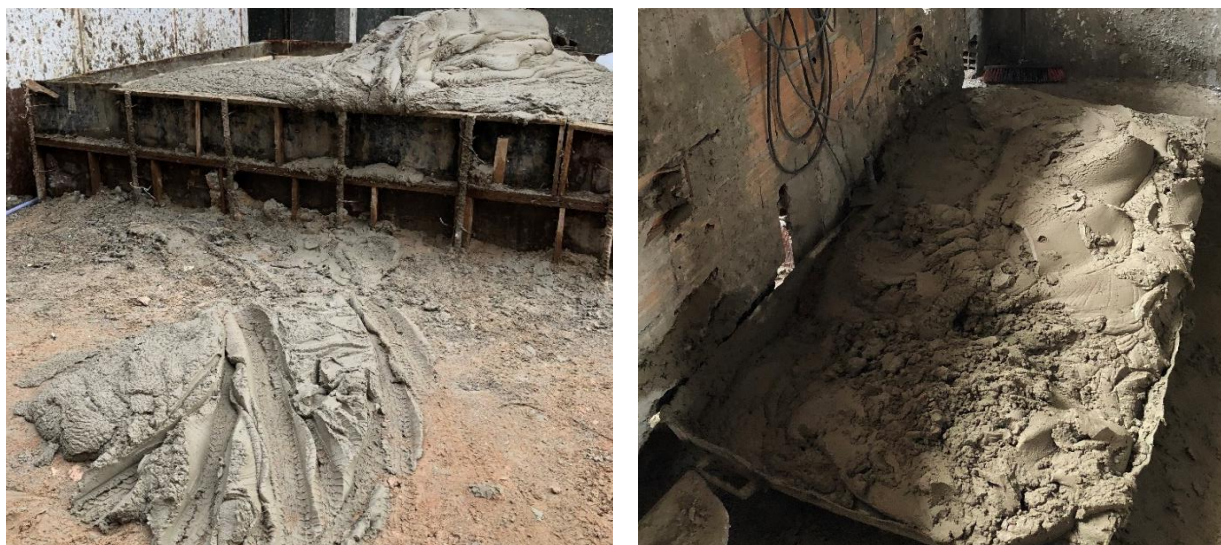
Figura 27- a) Desperdício de material gerado ao longo do transporte; b) endurecimento da argamassa no recipiente pelo transporte exacerbado ao pavimento
