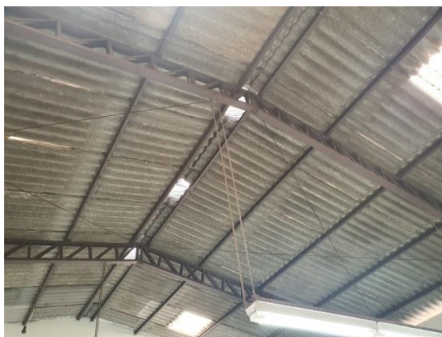
Figura 24 – Telhado com as telhas transparentes.
