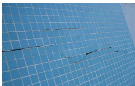
Figura 2. 9 – Fissuras em sistema de revestimento cerâmico (Bauer, 2010).
