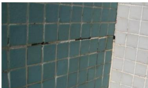
Figura 2. 7 – Falha nas juntas em sistema de revestimento cerâmico (Bauer, 2010).
