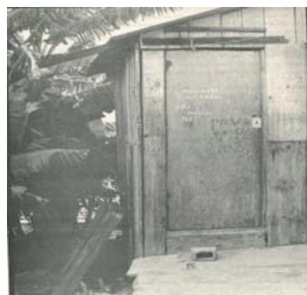
Fig. 5: Abrigo J. Flor da Primavera (SP). Ex. de precariedade na auto-construção (Bonduki e Rolnik, 1979: 64).
