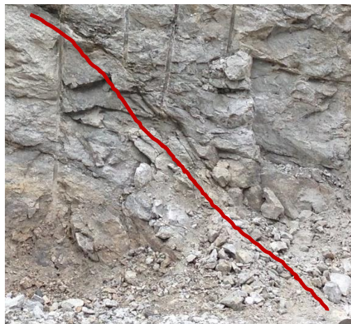
Figura 4.19. Maciço rochoso de carbonatito apresentando paredes da descontinuidade rugosa ondulada (ondulação da descontinuidade destacado em vermelho).
