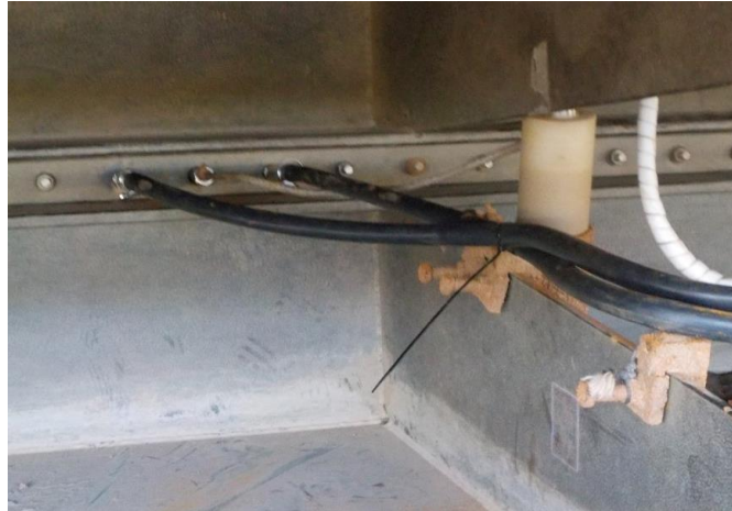
Figura 10. Detalhamento do cabeamento através do parafuso adaptado da tala entre os seguimentos e a bomba de baixa vazão para análise da qualidade da água (gaveta da comporta vagão entre o segundo e terceiro seguimento).
