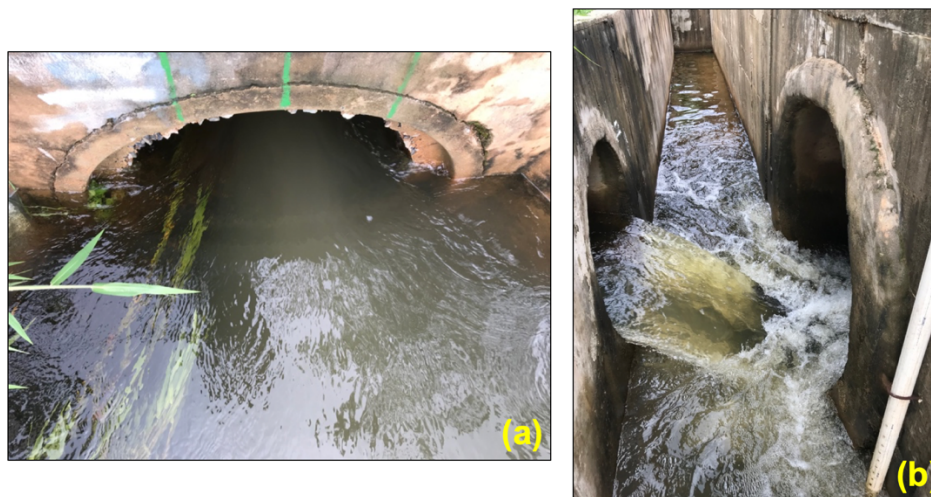
Figura 4.36 – Descarga de fundo: (a) Entrada; (b) Saída com direcionamento para tubulação de 1,5 m de diâmetro que desemboca no córrego Guará.
