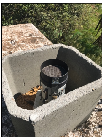
Figura 4.22 – Pluviógrafo instalado nas proximidades da bacia de detenção, em cima de estrutura da Caesb.
