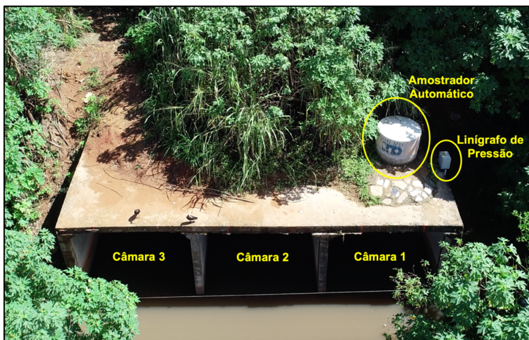
Figura 4.26 – Localização dos equipamentos de monitoramento na galeria de entrada da lagoa de detenção do Guará.
