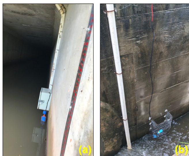
Figura 4.41 – (a) Boia de nível na posição vertical e tubulação que abriga a mangueira do amostrador e a fiação da boia no interior da câmara 1; (b) Tubulação para a mangueira do amostrador e boia de nível acionada no interior de gaiola de proteção, na saída da lagoa de detenção.
