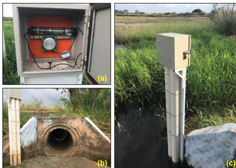
Figura 4.29 – (a) Linígrafo de boia instalado na saída da lagoa; (b) Vista frontal da descarga de fundo com estrutura do linígrafo de boia à esquerda da imagem; (c) Estrutura que abriga o linígrafo de boia.
