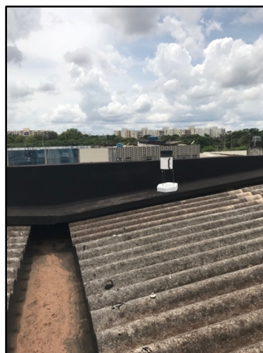
Figura 4.21 – Pluviógrafo no telhado de prédio comercial em SIA Quadra 5C.
