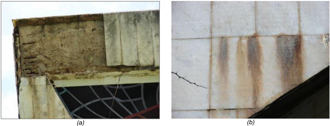
Figura 2.8: Panteão Tancredo Neves em Brasília, 1986, Oscar Niemeyer: a) destacamento de placa e armadura exposta; b) mancha de oxidação devido à corrosão dos elementos de fixação e ancoragem das placas. Fonte: Castro e Bauer, 2015.
