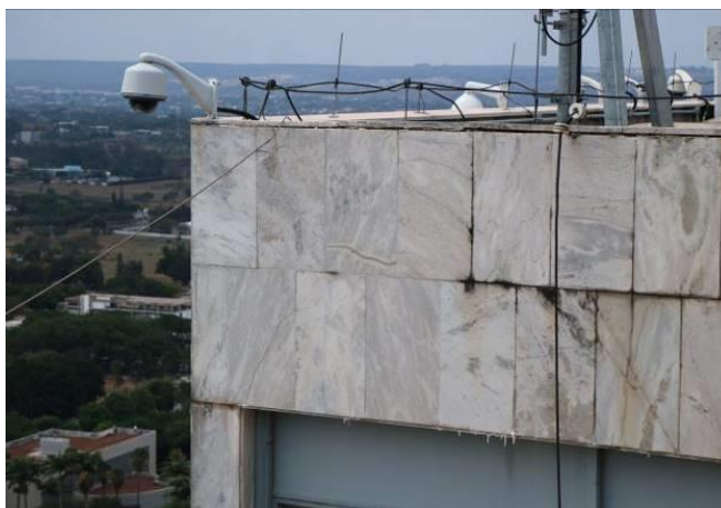
(h) Trecho da platibanda da torre Sul, com destaque para as interferências de instalações e a sobreposição de danos como fissuras, eflorescências e falhas no rejunte.
