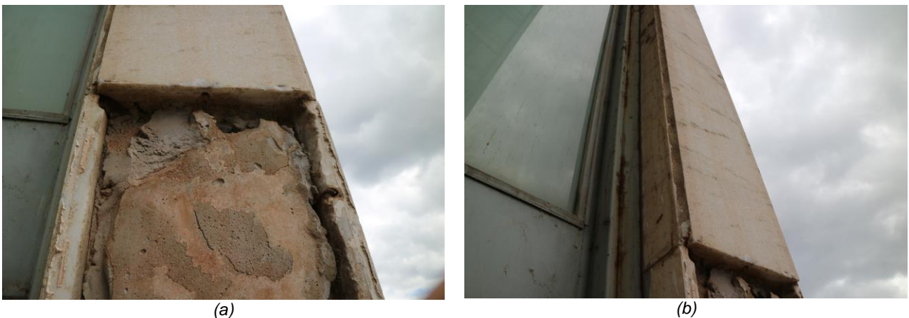
Figura 4.18: Prospecção 01: a) falhas na argamassa de assentamento; b) arremate com a esquadria. Fotos: Autora, 2017.
