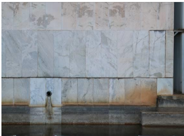
(e) Trecho da empena SE da torre Norte, com destaque para as placas substituídas e os danos causados pelo contato do sistema com o espelho.
