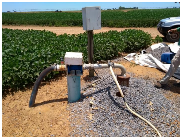
Figura 3.7. Poço tubular instalado sem proteção sanitária e com o pré-filtro composto por brita calcária até a superfície. Observa-se também um tupo repositivo necessário para o preenchimento de pré-filtro a medida que o poço produz areia do aquífero.
