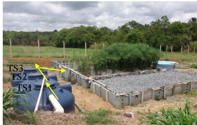
FIGURA 4. Vista dos três tanques sépticos (TS1, TS2 e TS3) e indicação do sentido de escoamento do esgoto e do sistema de zona de raízes.
