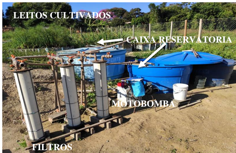
FIGURA 11. Sistema de tratamento de esgoto e filtros pressurizados instalados.
