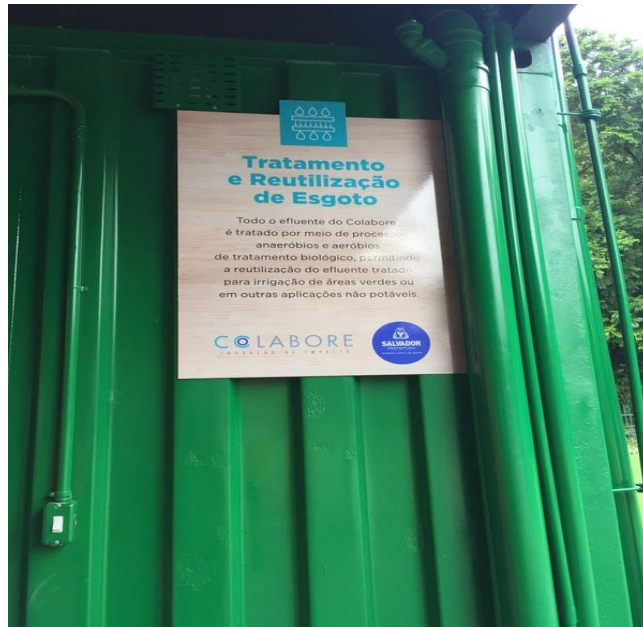
Figura 8- Placa explicativa sobre o sistema de tratamento e reutilização de esgoto do Colabore
