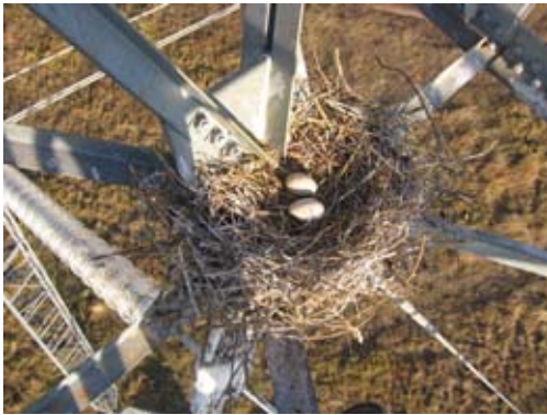
Ninho próximo a cadeia de isoladores
