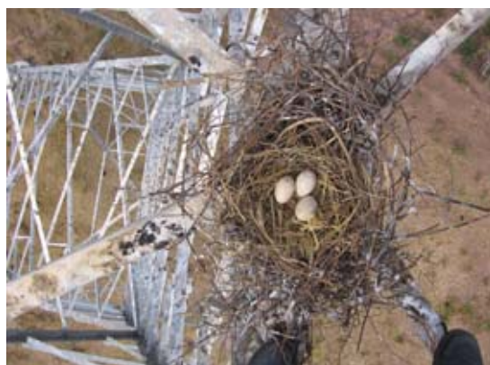
Contaminação da estrutura com fezes
