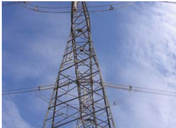
Ninhos na viga horizontal (direita e esquerda)
