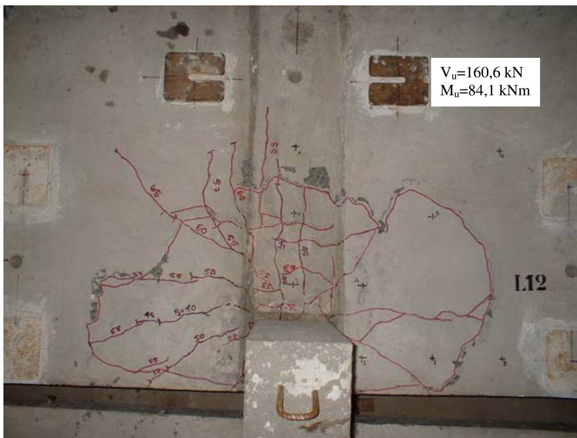
Figura 4.64 – Ruptura da laje do modelo L12.
