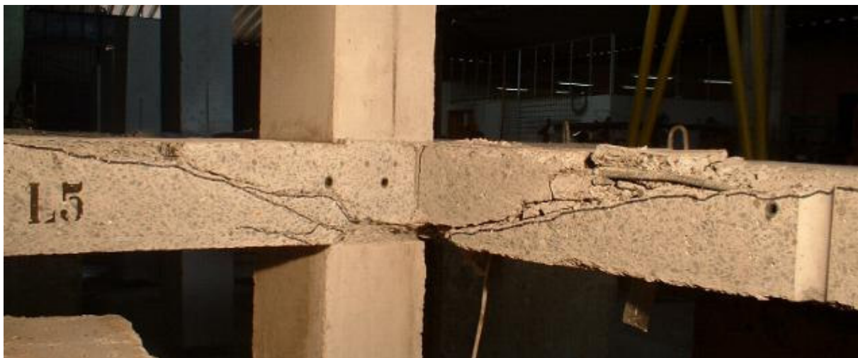
Figura 4.51 Seção transversal da ruptura laje L5
