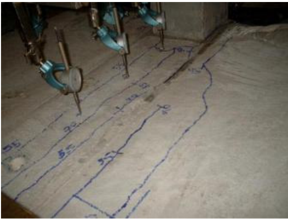
Primeiras fissuras: L1
