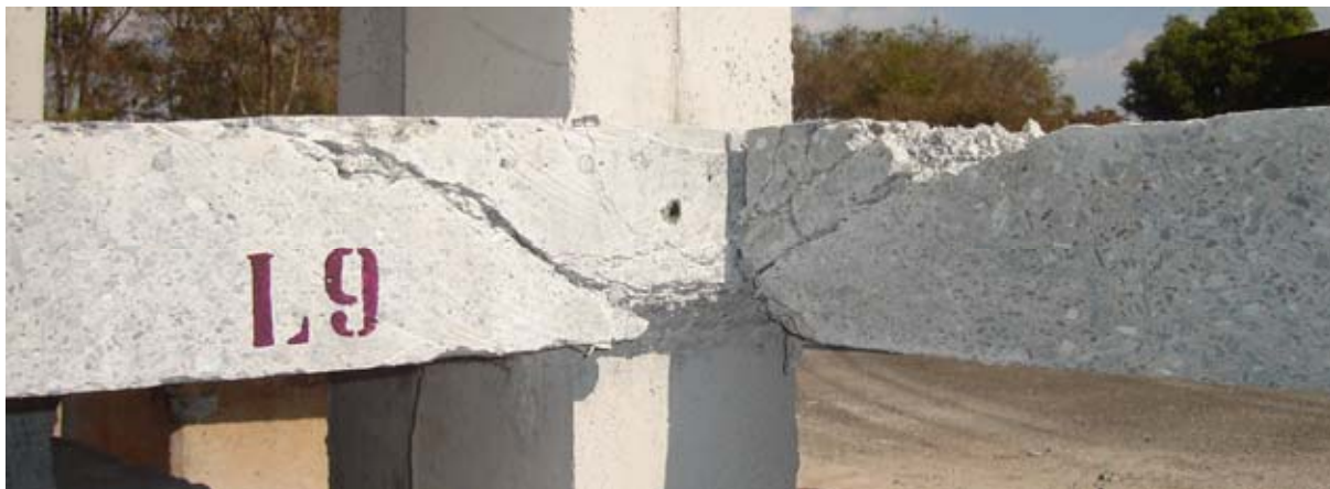
Figura 4.59 Seção transversal da ruptura laje L9
