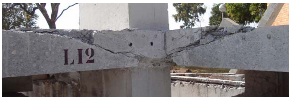
Figura 4.65 Seção transversal da ruptura laje L12
