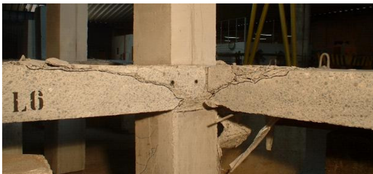
Figura 4.53 Seção transversal da ruptura laje L6
