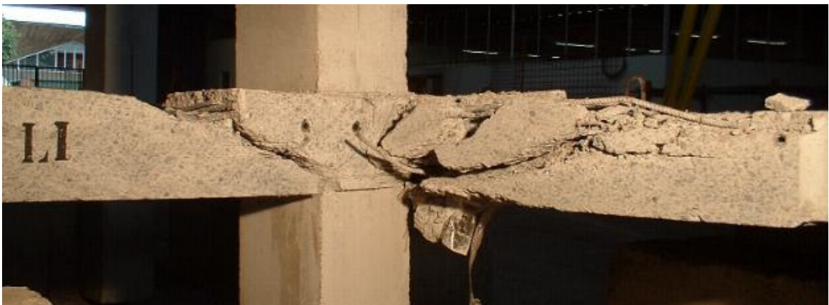
Figura 4.43 Seção transversal da ruptura laje L1
