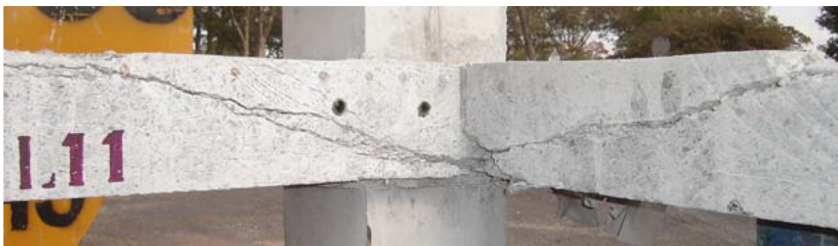
Figura 4.63 Seção transversal da ruptura laje L11
