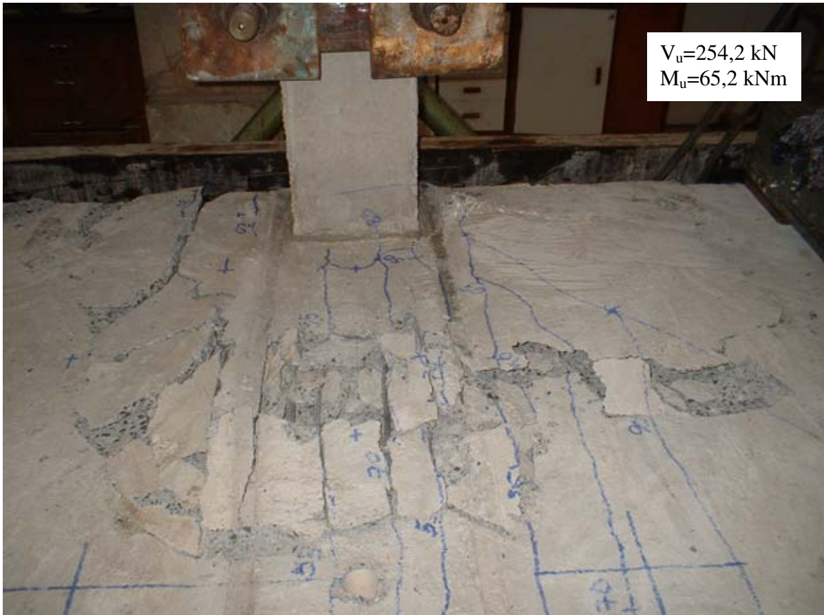
Figura 4.42 Ruptura da laje L1
