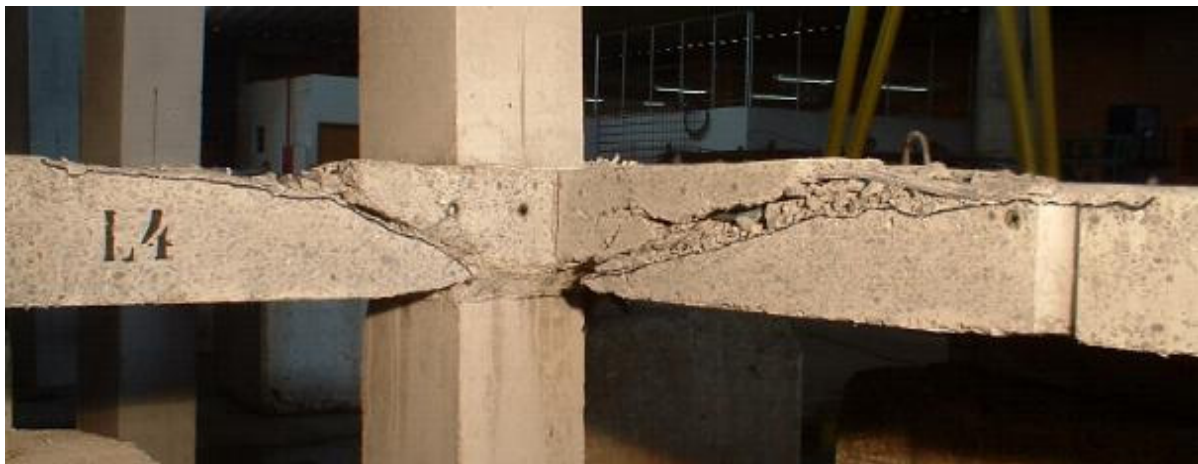
Figura 4.49 Seção transversal da ruptura laje L4
