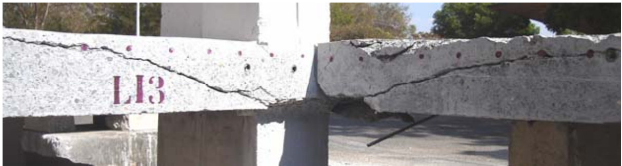
Figura 4.67 Seção transversal da ruptura laje L13
