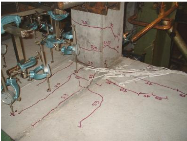
Primeiras fissuras L11
