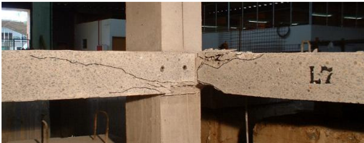
Figura 4.55 Seção transversal da ruptura laje L7
