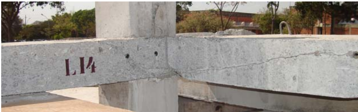
Figura 4.69 Seção transversal da ruptura laje L14
