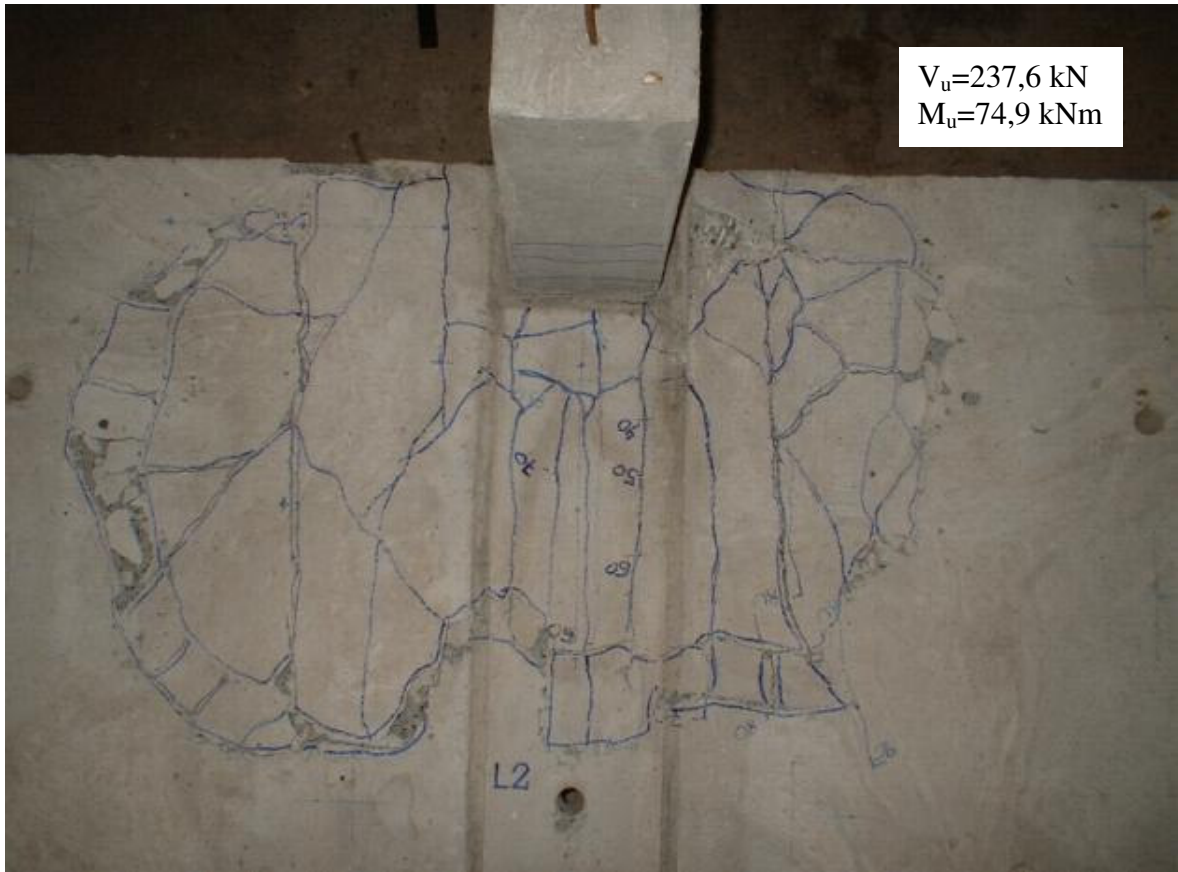
Figura 4.44 Ruptura da laje L2
