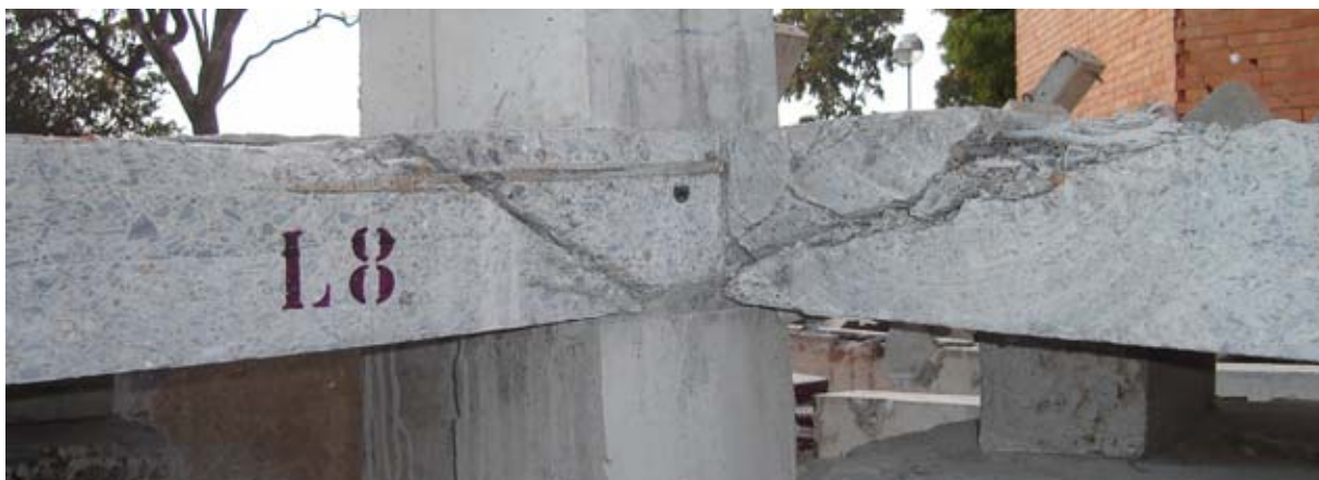
Figura 4.57 Seção transversal da ruptura laje L8
