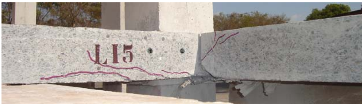
Figura 4.71 Seção transversal da ruptura laje L15
