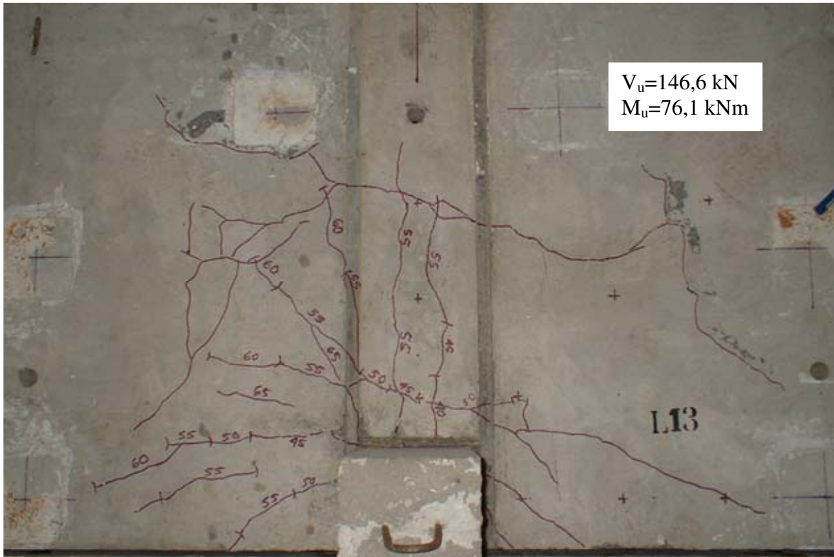
Figura 4.66 Ruptura da laje do modelo L13
