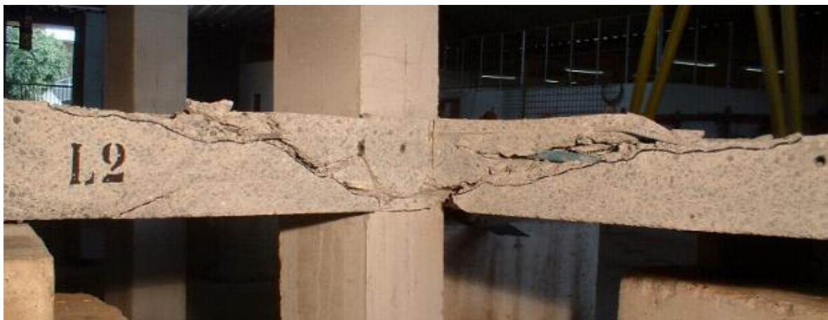
Figura 4.45 Seção transversal da ruptura laje L2
