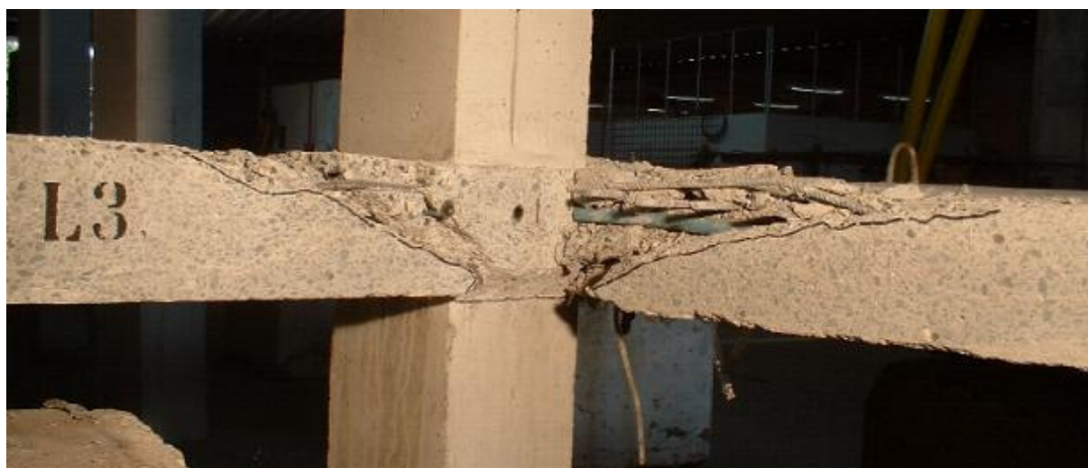
Figura 4.47 Seção transversal da ruptura laje L3
