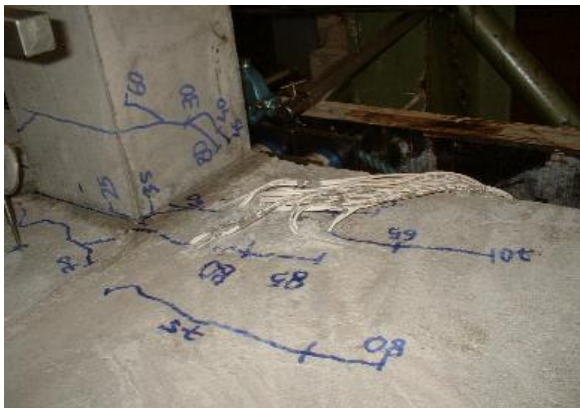
Primeiras fissuras: L7
