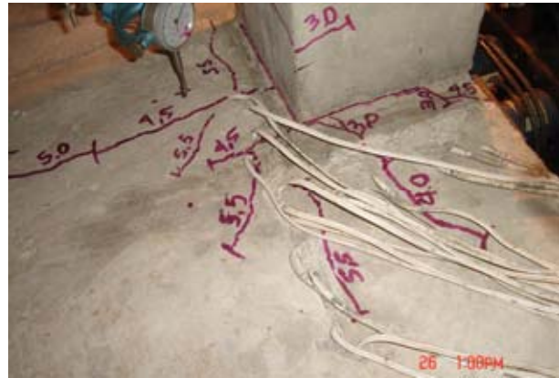
Primeiras fissuras L14
