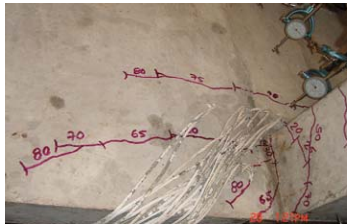
Primeiras fissuras L15
