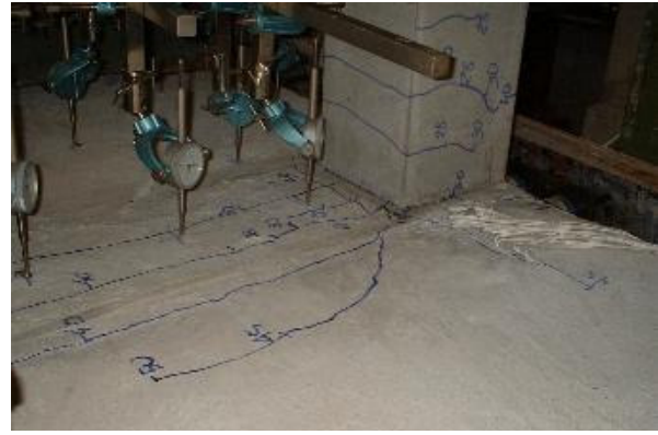
Primeiras fissuras: L4
