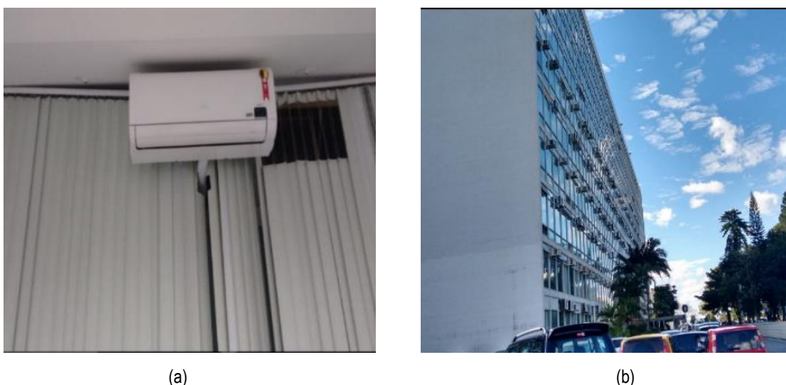
Figura 4.13 - Sistema independente (janela e Split) - vista interna e externa (a) e (b) do MCTIC.
