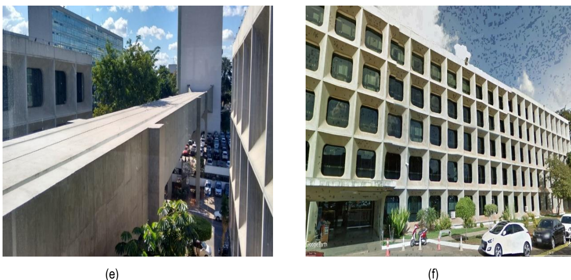
Figura 4.17 - Registro fotográfico in loco , cobertura (a), (b), (c), (d), túnel de acesso (e) e fachada (f).
