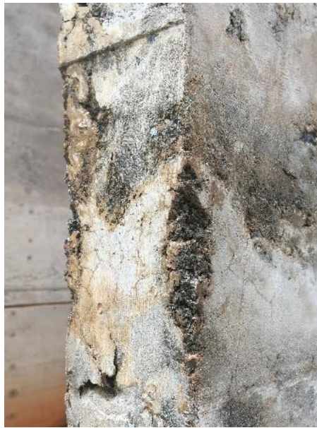
Figura 2.13 - Registro fotográfico da manifestação patológica perda de seção, realizado na fachada do edifício da Biblioteca Central da Universidade de Brasília, em Brasília/DF. Fonte: AUTORA, 2018.
