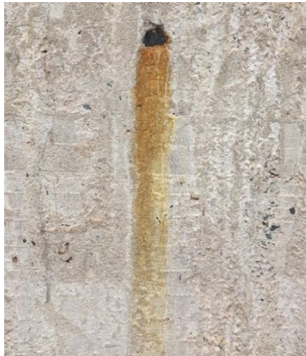
Figura 2.14 - Registro fotográfico de uma mancha de corrosão, realizado em uma das fachadas do Anexo do Palácio Itamaraty, em Brasília/DF. Fonte: AUTORA, 2018.
