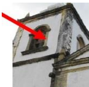
Figura 4.6 - Registro fotográfico, feito por Teles (2016), de prováveis eflorescências provenientes da alta porosidade da pedra calcária. Fonte: TELES et al. , 2016.
