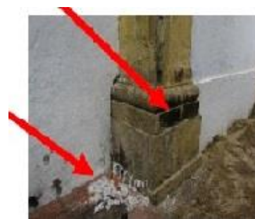
Figura 4.7 - Registro fotográfico, feito por Teles (2016), de danos causados por velas acesas. Fonte: TELES et al. , 2016.
