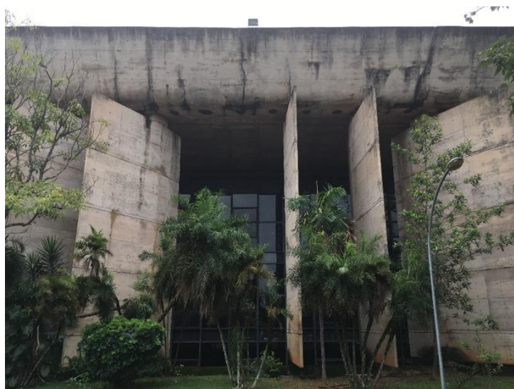
Figura 2.12 - Registro fotográfico de manifestações patológicas da tipologia mancha, realizado na fachada do edifício da Biblioteca Central da Universidade de Brasília, em Brasília/DF.
