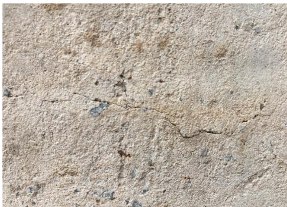
Figura 2.5 - Registro fotográfico de uma fissura, realizado em uma das fachadas do Anexo do Palácio Itamaraty, em Brasília/DF. Fonte: AUTORA, 2018.
