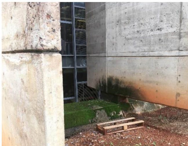
Figura 2.4 - Registro fotográfico de um tipo de ataque biológico, realizado na fachada do edifício da Biblioteca Central da Universidade de Brasília, em Brasília/DF. Fonte: AUTORA, 2018.
