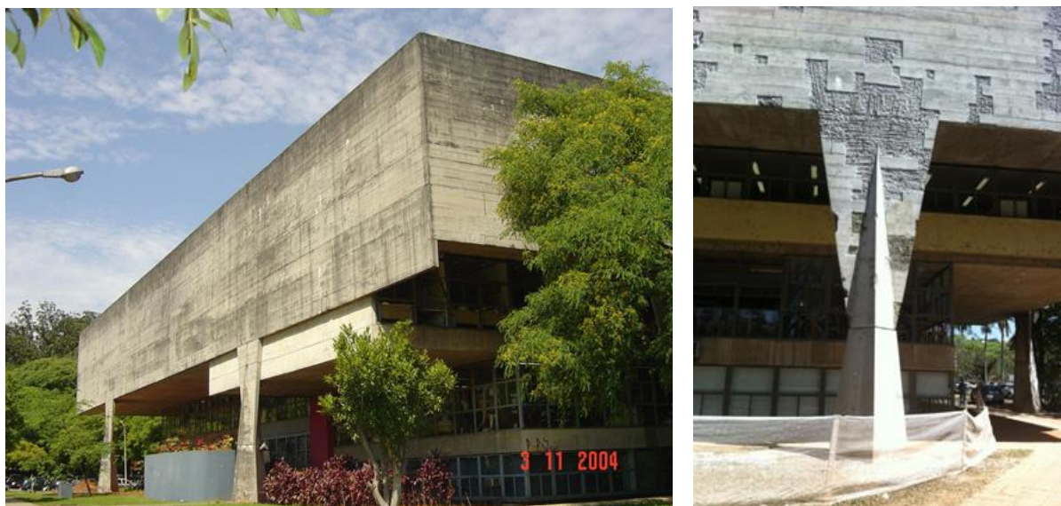
Figura 6.3 – a) Levantamento fotográfico da fachada Sudeste realizado por Simões. Fonte: SIMÕES, 2004; CONSERVA FAU, 2017; b) Registro fotográfico do trabalho de remoção do concreto com perda de massa. Fonte: OLIVEIRA, 2014; EQUIPE CONSERVA FAU, 2017.
