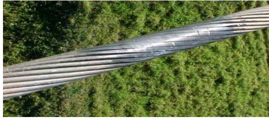
Figura 3.3 - Abrasão dos fios de um condutor pelo aperto da braçadeira (CIGRÉ, 2005).
