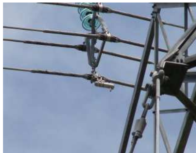
(b) Vibrec 642 instalado
