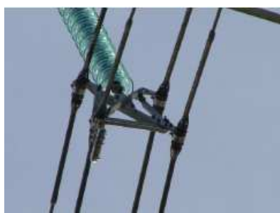
(b) Vibrec 642 instalado
