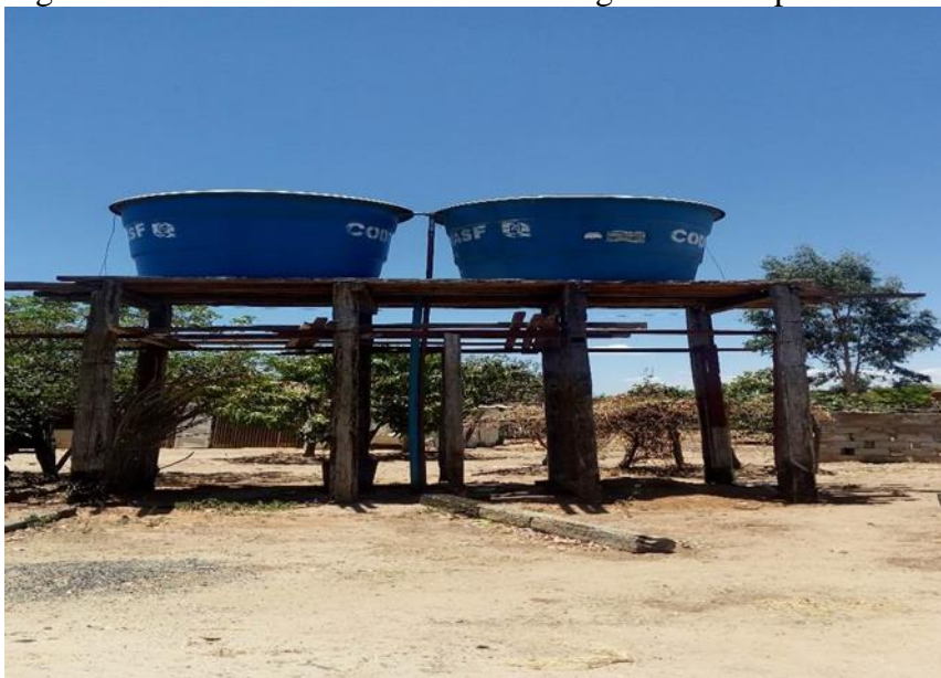
Figura 13- Sistema de abastecimento de água do acampamento
