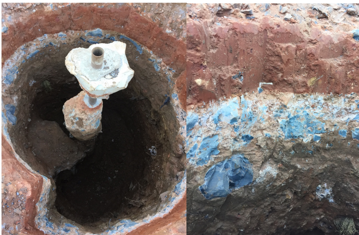
Figura 5.6 – Escavação do furo piloto 1, em que haviam 2 manchetes/m, e detalhe da parede da escavação. Formou-se uma lente de 200 mm circular, semelhante a uma laje
