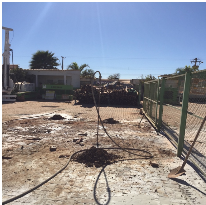
Figura 5.13 – Injeção das manchetes mais rasas, mangueira e obturador inseridos no tubo PVC manchettato
