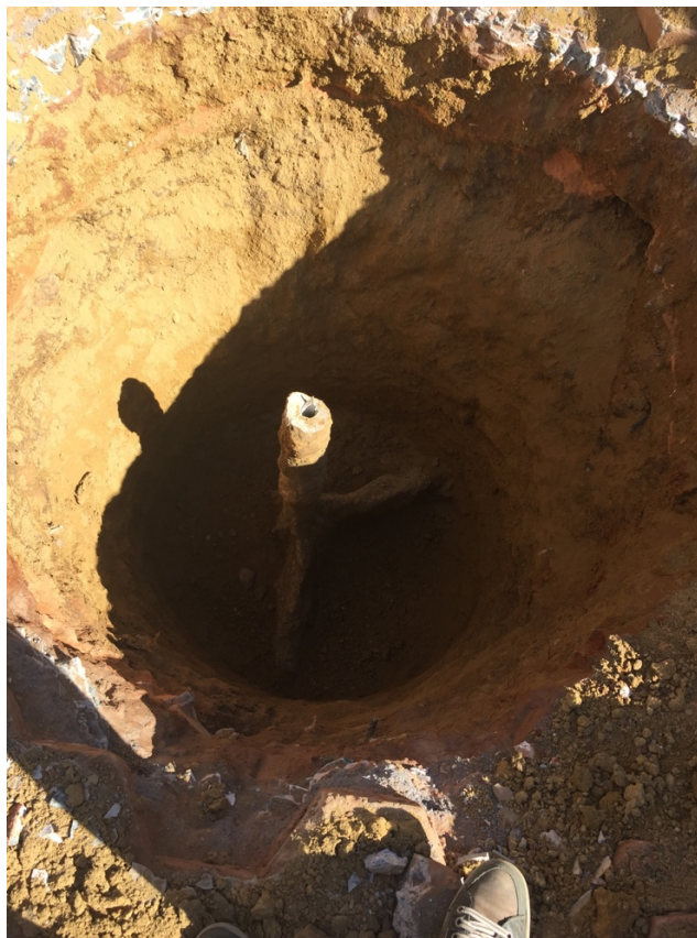
Figura 5.7 – Escavação do furo piloto 2, em que haviam 3 manchetes/m. Observou-se um mecanismo de deslocamento do solo circundante, com a calda de cimento endurecida próxima às manchetes
