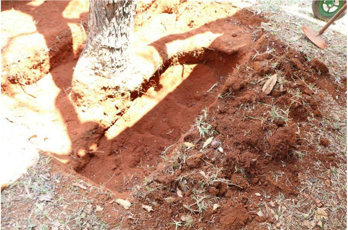
Imagem 10 – Escavação nos estágios iniciais, à direita do “pequizeiro”, já sendo preparada a extensão na direção norte
