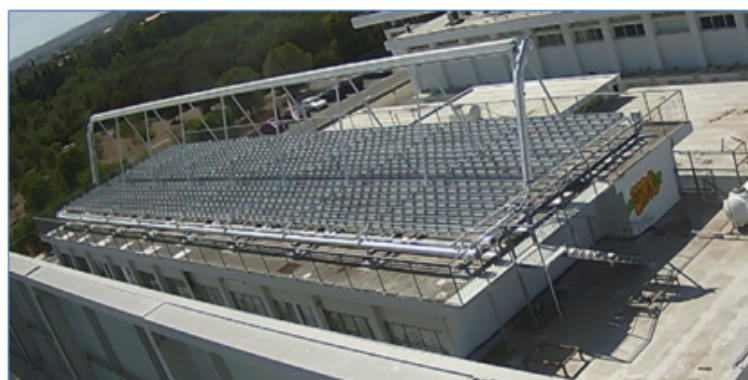
Figura 10 – Sistema Linear Fresnel instalado no alto de um edifício.
