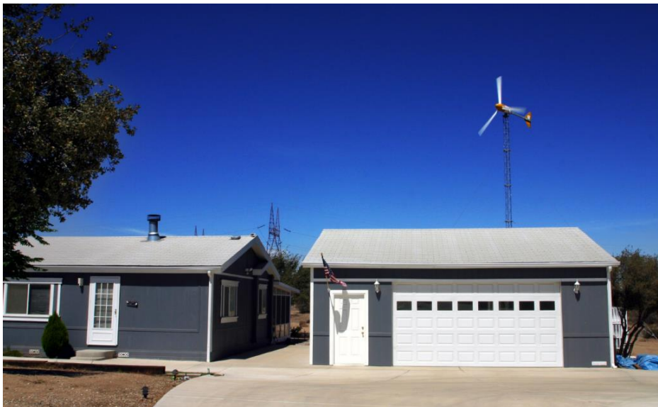
Figura 2.3 – Pequena turbina eólica instalada em residência unifamiliar. (Fonte: https://www.energy.gov/energysaver/articles/want-tax-credit-small-wind-system-be-sure-its-certified . Acesso em 02 de fevereiro de 2017).
