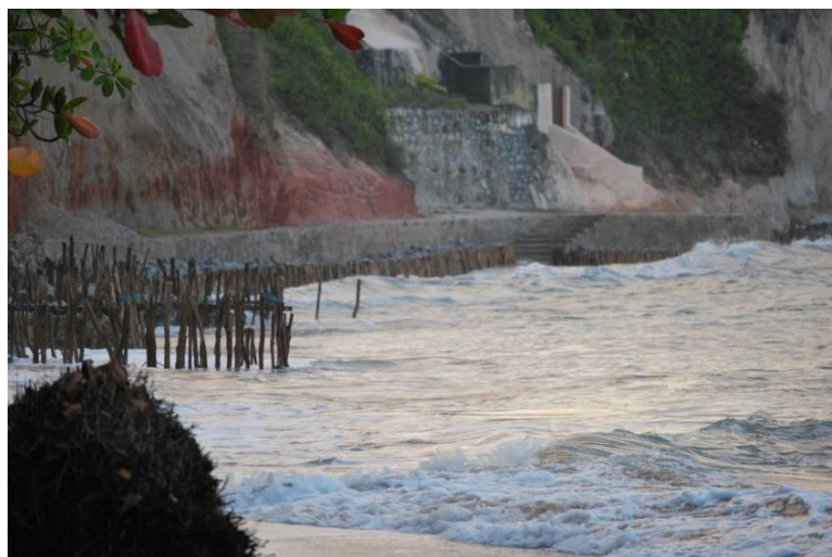
Figura 5.41 - Medida de contenção da base da falésia, maré 2.3 m
