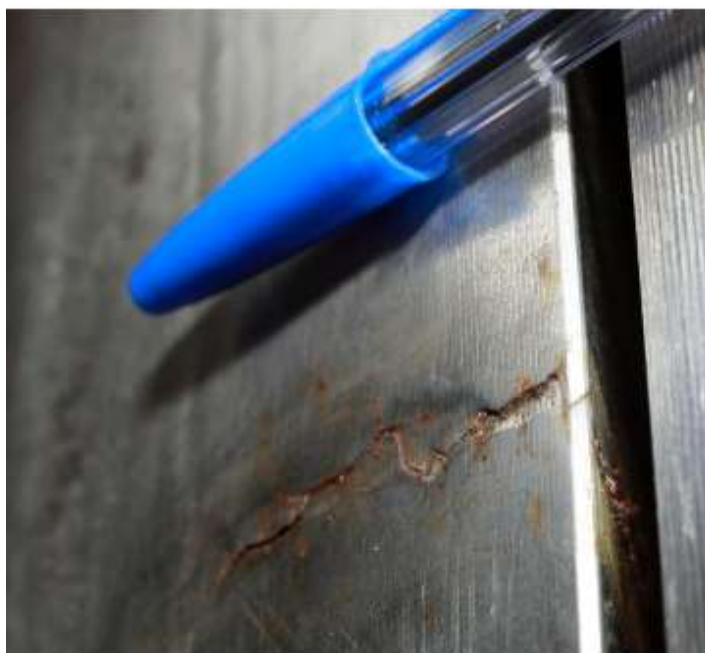
Figura 2 - Trinca identificada no anel de desgaste da unidade número 6 de Itaipu (JORNAL ELETRÔNICO DE ITAIPU, 2011)
