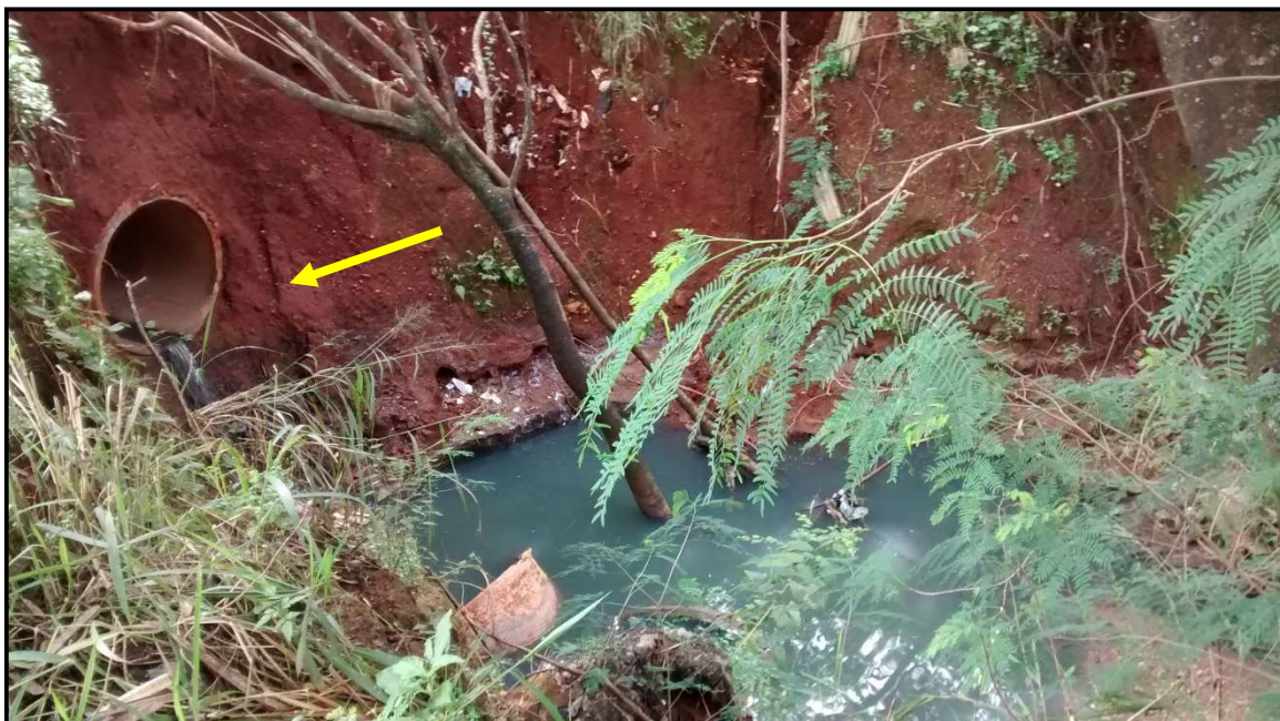
Figura 9 - Lançamento de esgoto em galeria de água pluvial, que desagua no ponto de coleta de água PRA02, Ribeirão Anicuns.
