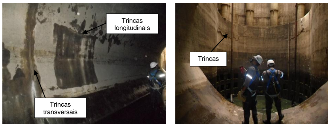
Figura 3.10. Trincas ao interior do túnel de conexão do poço de grelhas ao poço de bombeamento 1 (Mondragón, 2015)
