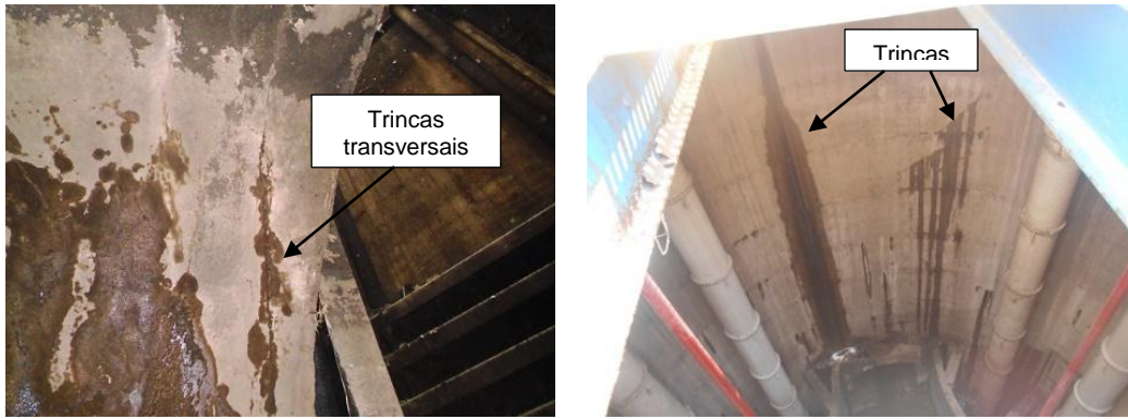
Figura 3.12. Fissuração observada no interior do poço de bombeamento 2 (Mondragón, 2015)
