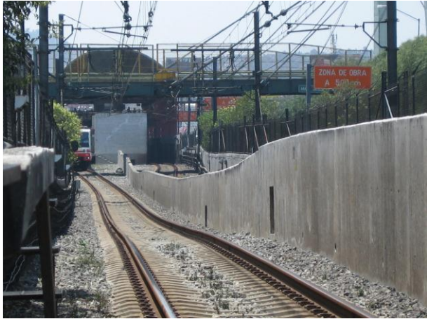
Figura 2.15. Deformação da caixa da linha A do Metrô (Zaldivar, 2013)
