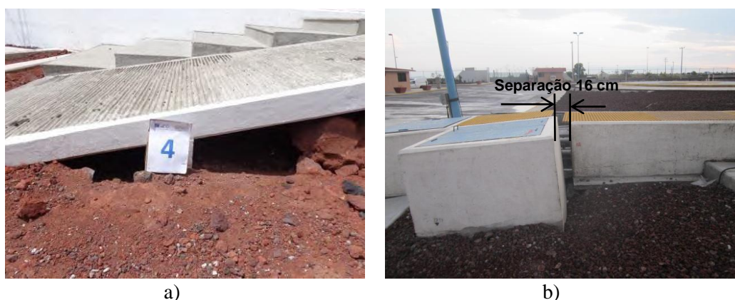
Figura 3.11. Danos superficiais no poço de bombeamento 1- (a) Subsidência superficial sob a rampa de acesso ao PB-1; (b) Inclinação e separação das estruturas superficiais perto do PB-1. (CONAGUA, 2014).
