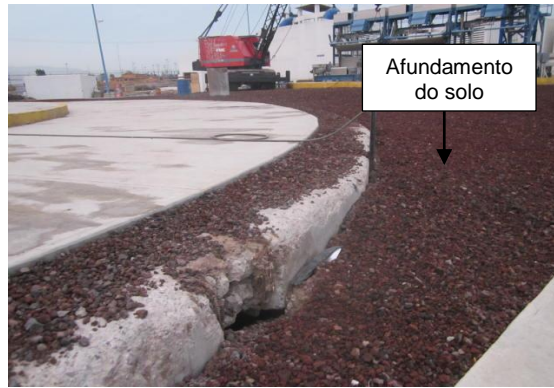
Figura 3.7. Recalques ao redor do poço 6 (CONAGUA, 2013)
