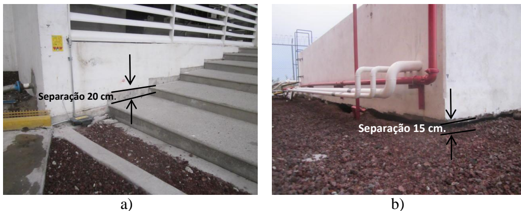
Figura 3.13. Efeitos da subsidência regional na usina de bombeamento- (a) Afundamento das escadas que conduzem ao poço de bombeamento 2; (b) Separação entre a parede dos tanques e o solo (CONAGUA, 2014).
