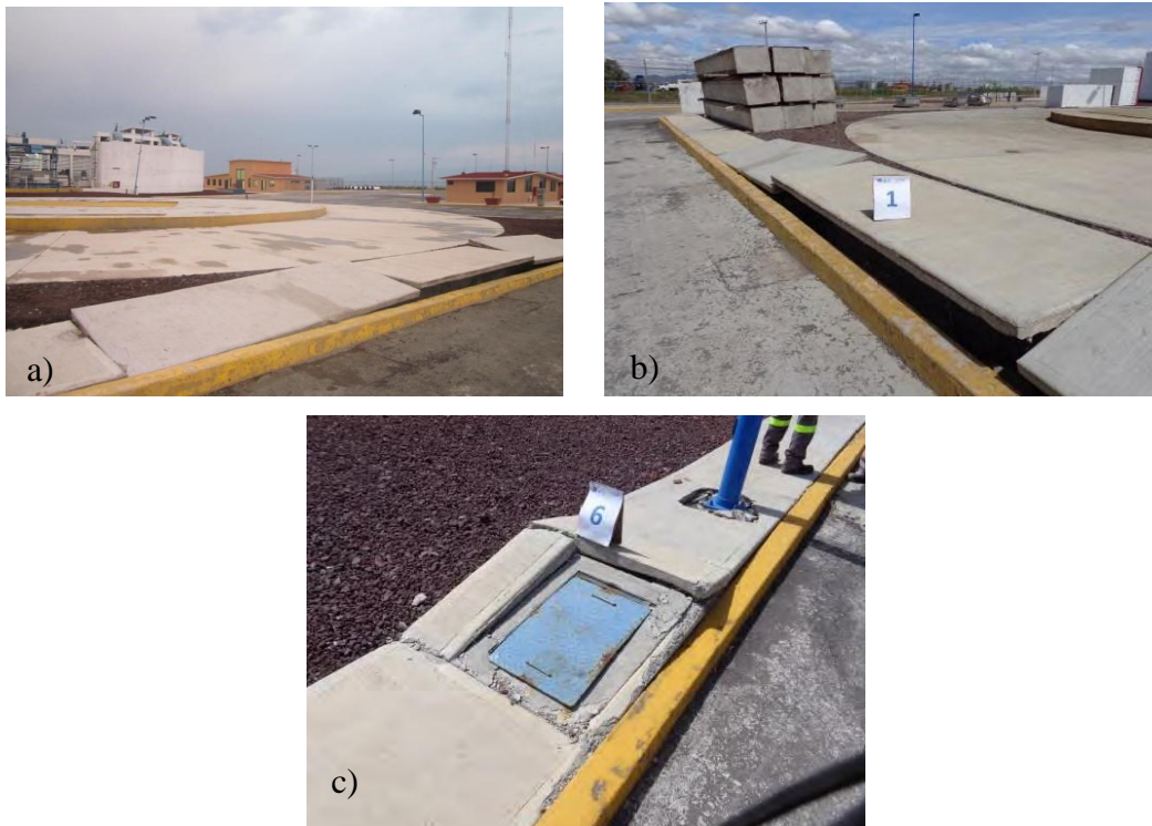
Figura 3.8. Separação das placas de concreto do solo - Poço 6 (CONAGUA, 2014).
