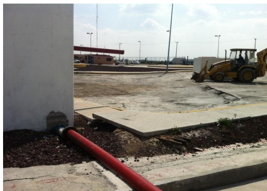
Figura 3.9. Subsidência superficial no sentido do poço de grelhas (CONAGUA, 2014)
