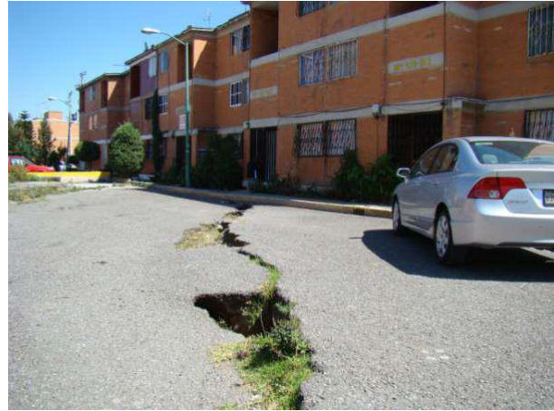
Figura 2.16. Trinca característica numa zona de transição (Santoyo, 2008)
