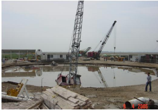
Figura 3.16. Ruptura do poço 6 da usina de bombeamento (Zaldivar, 2013)
