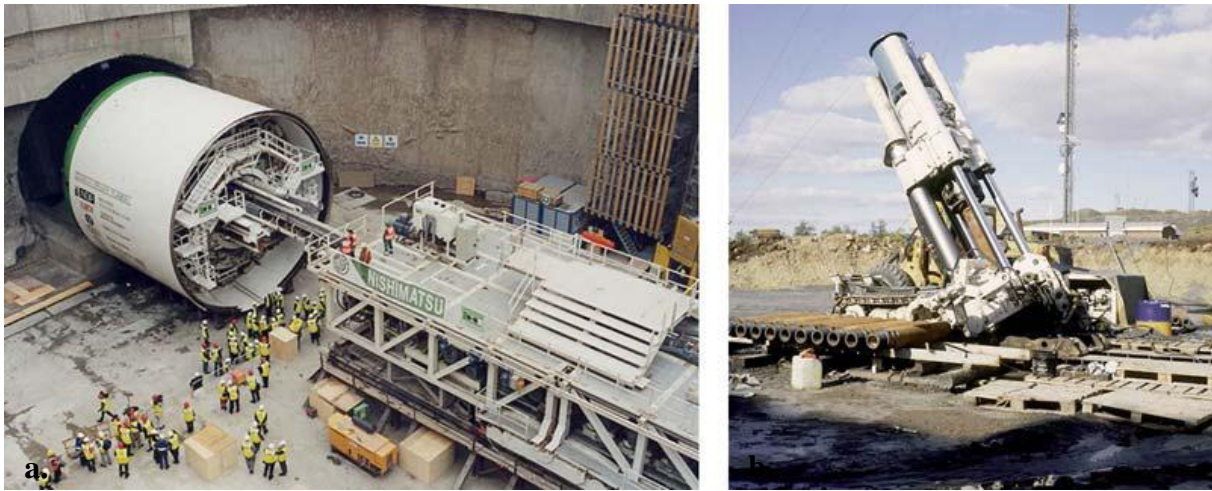
Figura 2.5 a) Início de Escavação na Via Mockingbird, DART – Dallas. b) Máquina de Escavação para Poço Inclinado na Mina de Copper - Bolívia, (Sauer & Mergelsberg, 2003)
