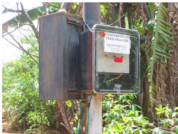
Figura 4.5 - Instalação do aparelho registrador em campo.
