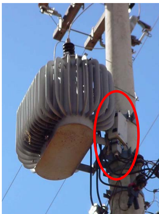
Figura 4.6 - Analisador de qualidade de energia fixado entre o transformador e o poste.
