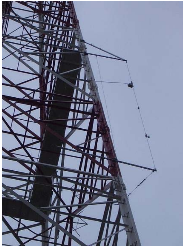
Figura 3.3 – Antena utilizada durante os testes instalada na torre de transmissão.
