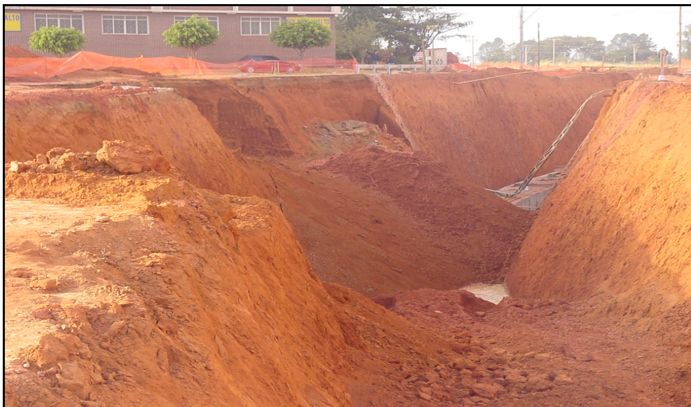
Figura 1.2 – Ruptura do talude no trecho curvo.
