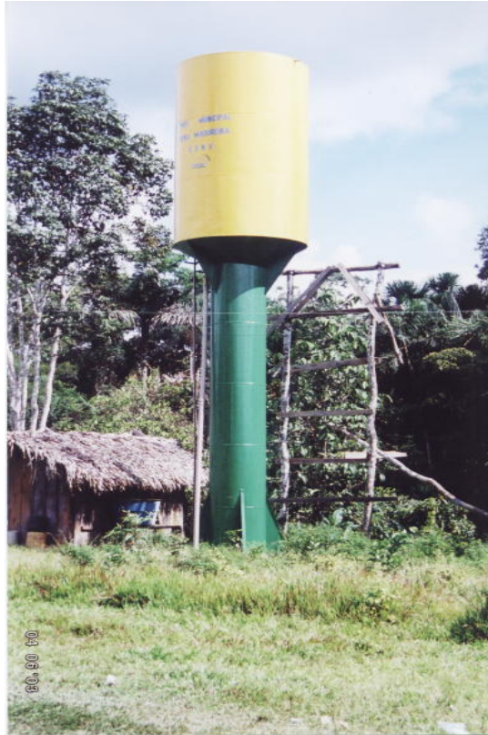
Foto 9: Vista do Reservatório d'água que abastece a comunidade de Cazumbá.
