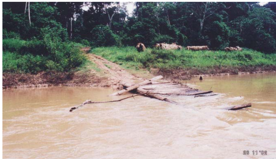
Foto 12: Detalhe da ponte sobre o rio Caeté, na estrada de acesso, destruída durante a cheia do rio.
