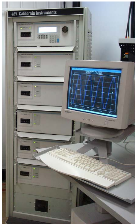
Figura 3. 3- Fonte de alimentação, com potência de 30 kVA, comandada remotamente.
