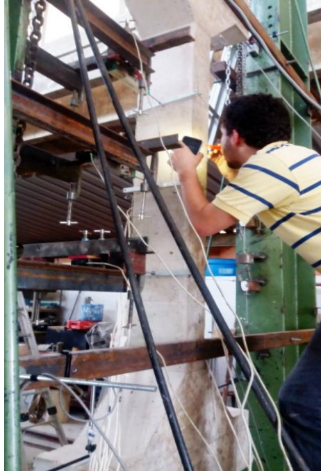
Figura 3.51 – Acompanhamento e marcação das fissuras
