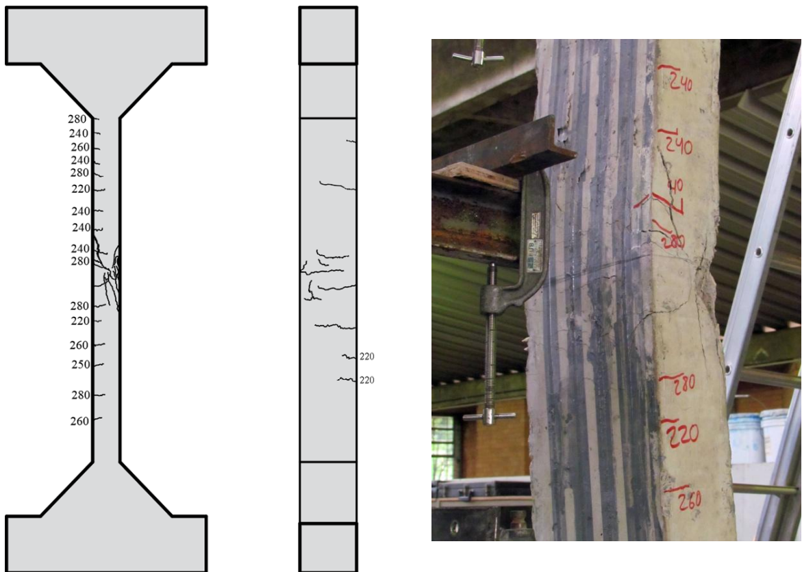
Figura 4.31 – Fissuras do Pilar C30S
