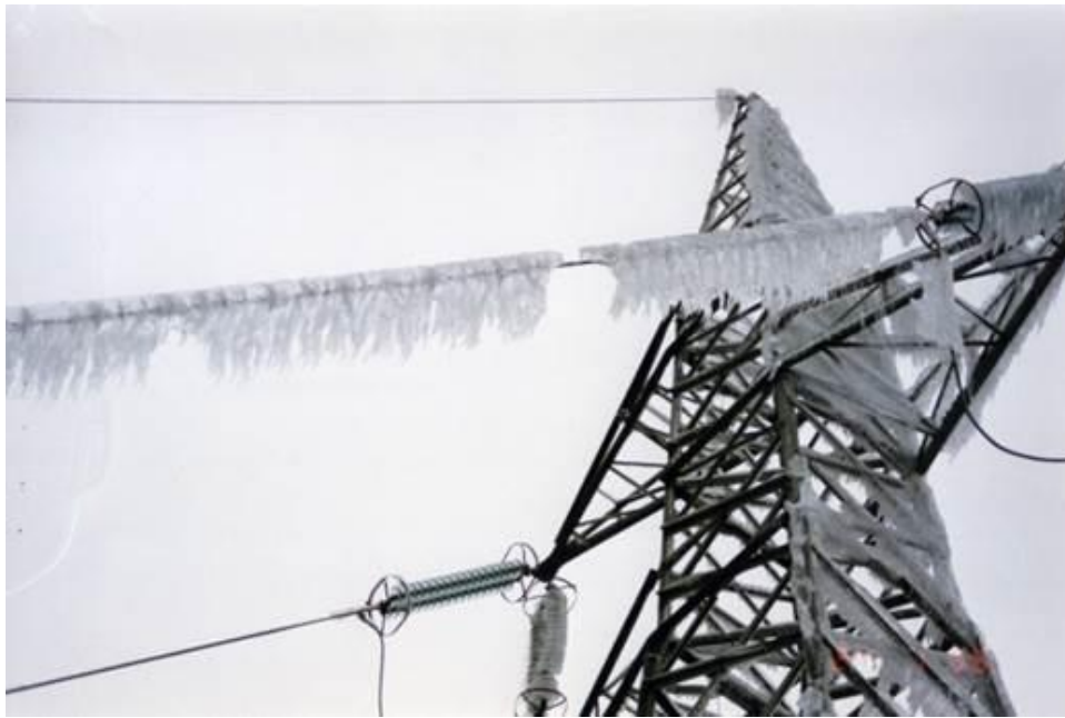
Figura 2.6 – Linha de transmissão com depósito de gelo.
