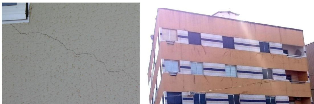
Figura 2.9 – Exemplos de fissuração na região das aberturas (SANTOS, 2017).
