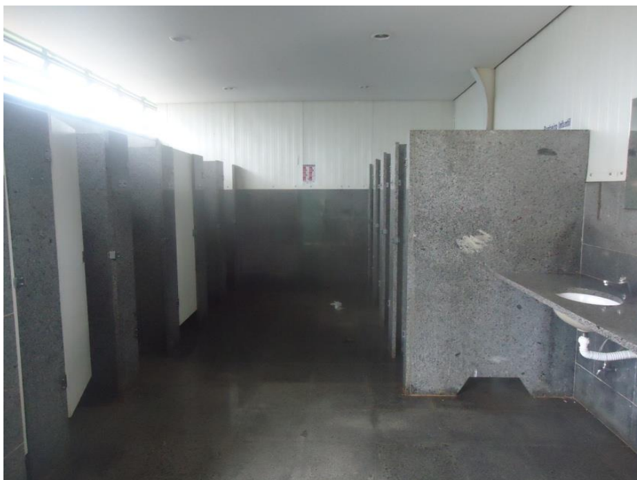
Figura 32 - Banheiro da Feira de Artesanato da Torre de TV
