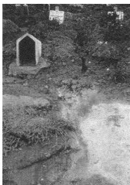
FIGURA 257: Extravasamento de necrochorume de cova rasa no cemitério de V. Nova Cachoeirinha (SP). Segundo o autor, quanto mais superficial é a sepultura, maior o risco de contaminação deste tipo.
