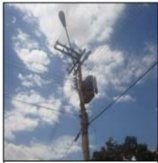
Figura 15: Transformador de rede de distribuição de energia elétrica operada pela CEB.
