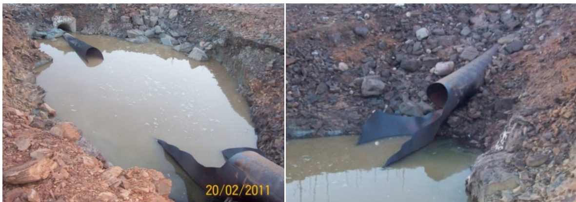
Figura 2.11. Explosão em gasoduto na cidade de Beardmore, Canadá (TSB, 2011).
