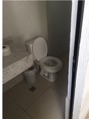
Figura 55 – Equipamentos sanitários inadequados para o uso de PMR. Fonte: autora
