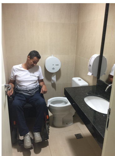
Figura 88 – Instalação sanitária inadequada no mezanino da torre comercial. Fonte: autora
