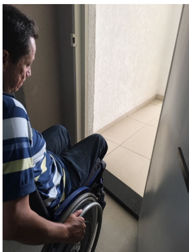
Figura 52 – Desnível na porta de acesso para área de lazer. Fonte: autora.
