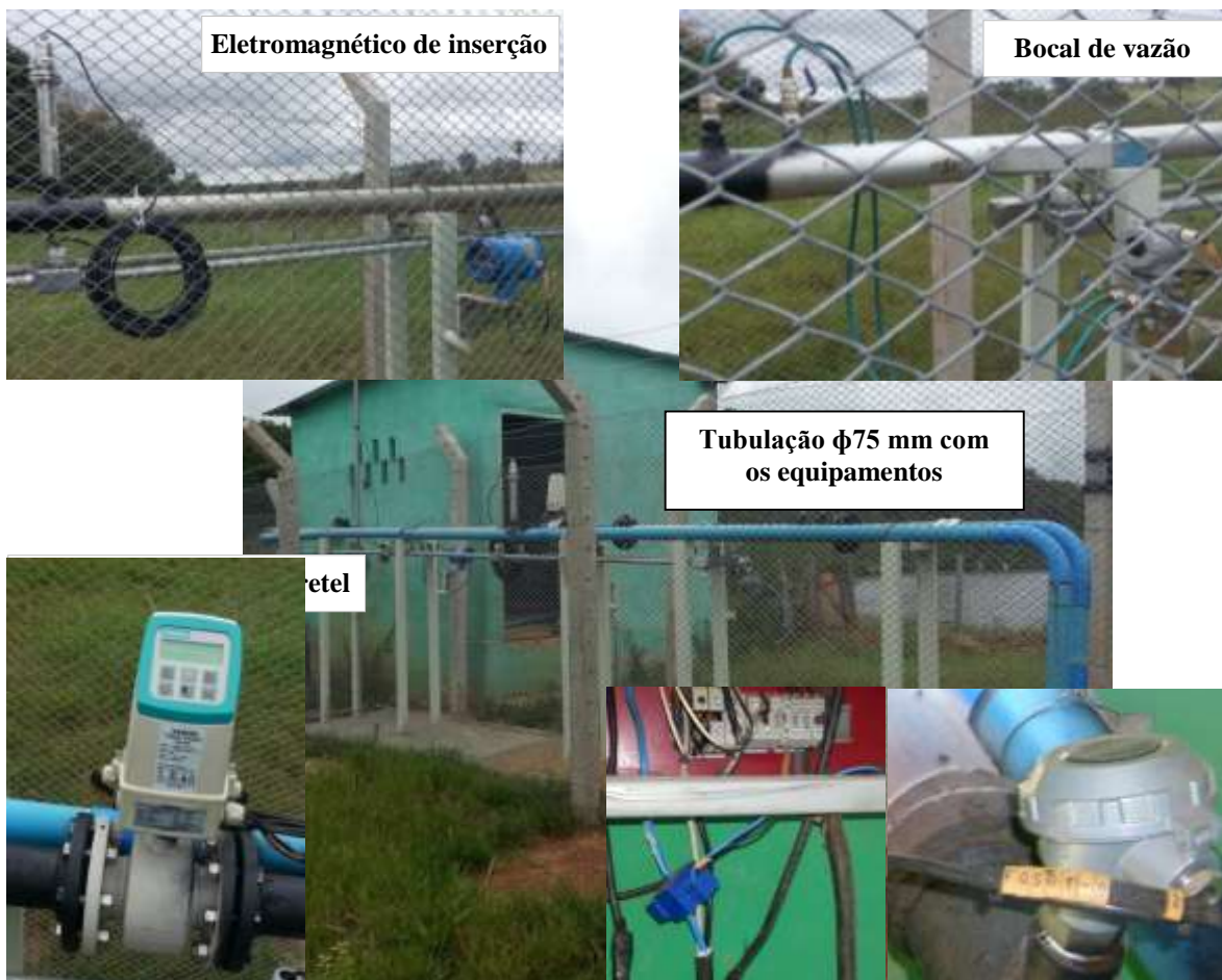
Figura C.4 – Estação 2 - Areal: ponto de captação com tubulação de diâmetro de 75mm e equipamentos instalados.
