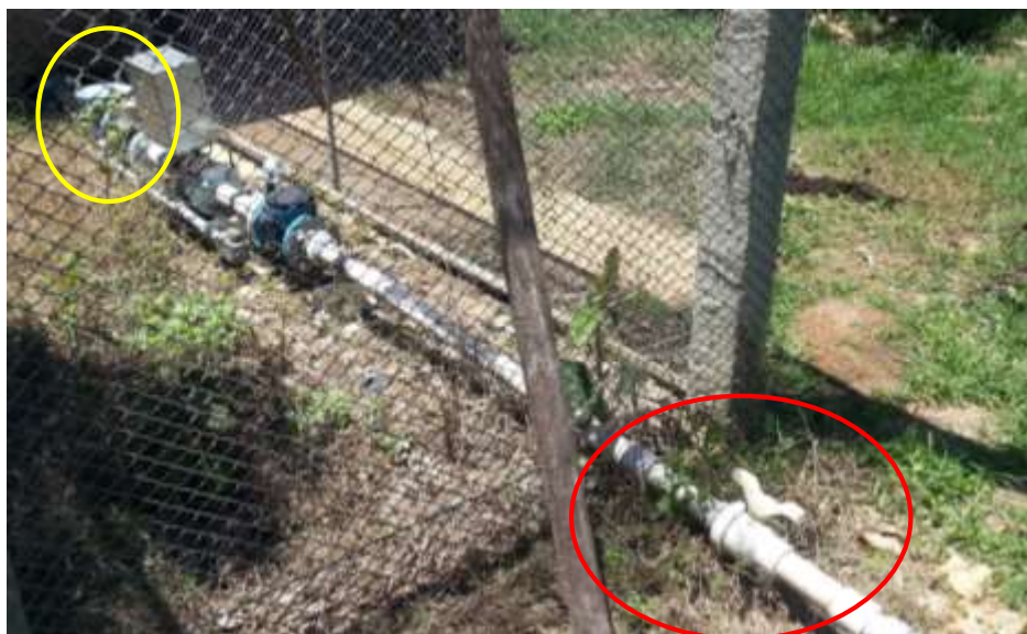
Figura C.25 – Estação 3 – Magela: detalhe da válvula de pressão instalada no final, para diminuição da vazão, para envio de água às estufas mais próximas
