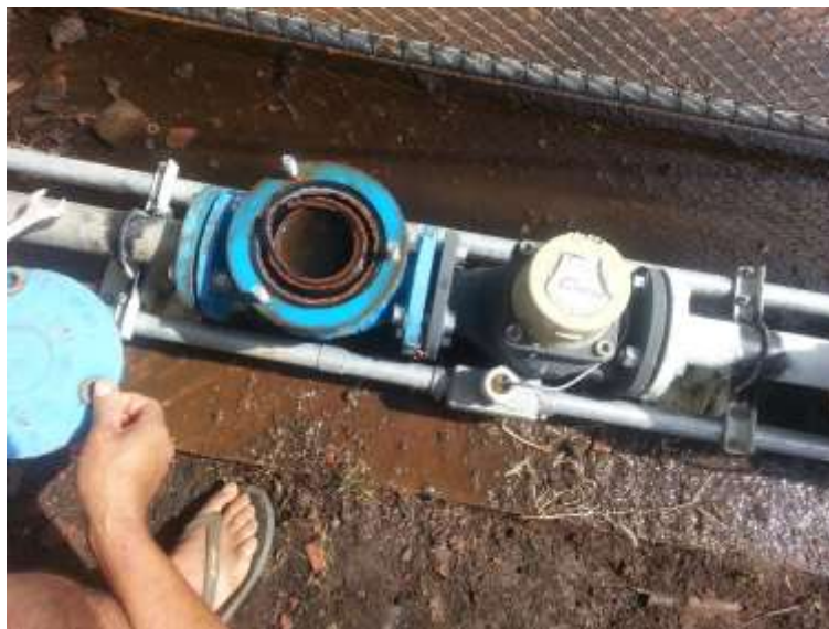
Figura C.26 – Estação 3 – Magela: limpeza de filtro de disco (esq.) instalado antes do hidrômetro (dir.)
