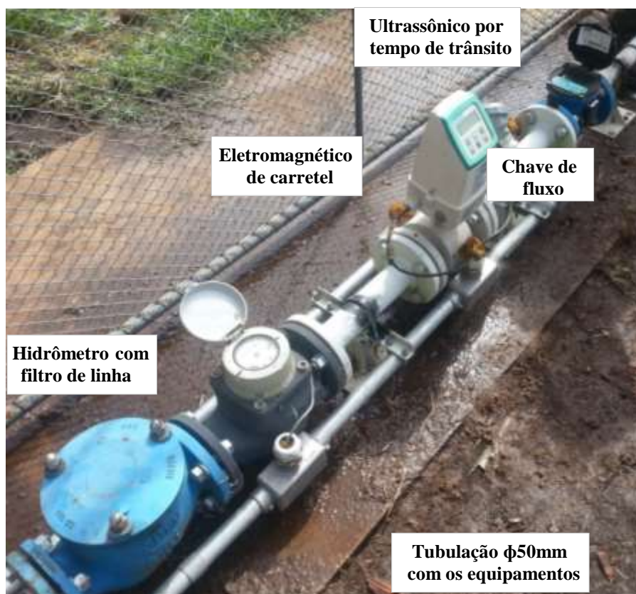
Figura C.5 – Estação 3-Geraldo Magela: tubulação de saída com diâm. 50mm e equip. instalados.
