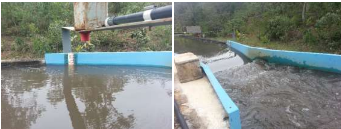
Figura C.33 – Calha Parshall com maior nível d’água nos dois anos de operação, em 19 de fevereiro de 2015, sem afogamento
