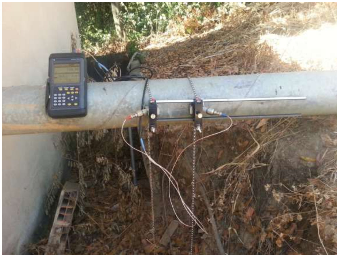
Figura C.16 – Estação 1 – Mazurek: Medição de vazão utilizando ultrassônico por tempo de trânsito, em 2 de julho de 2015 – vazão média: 157,1 m 3 /h
