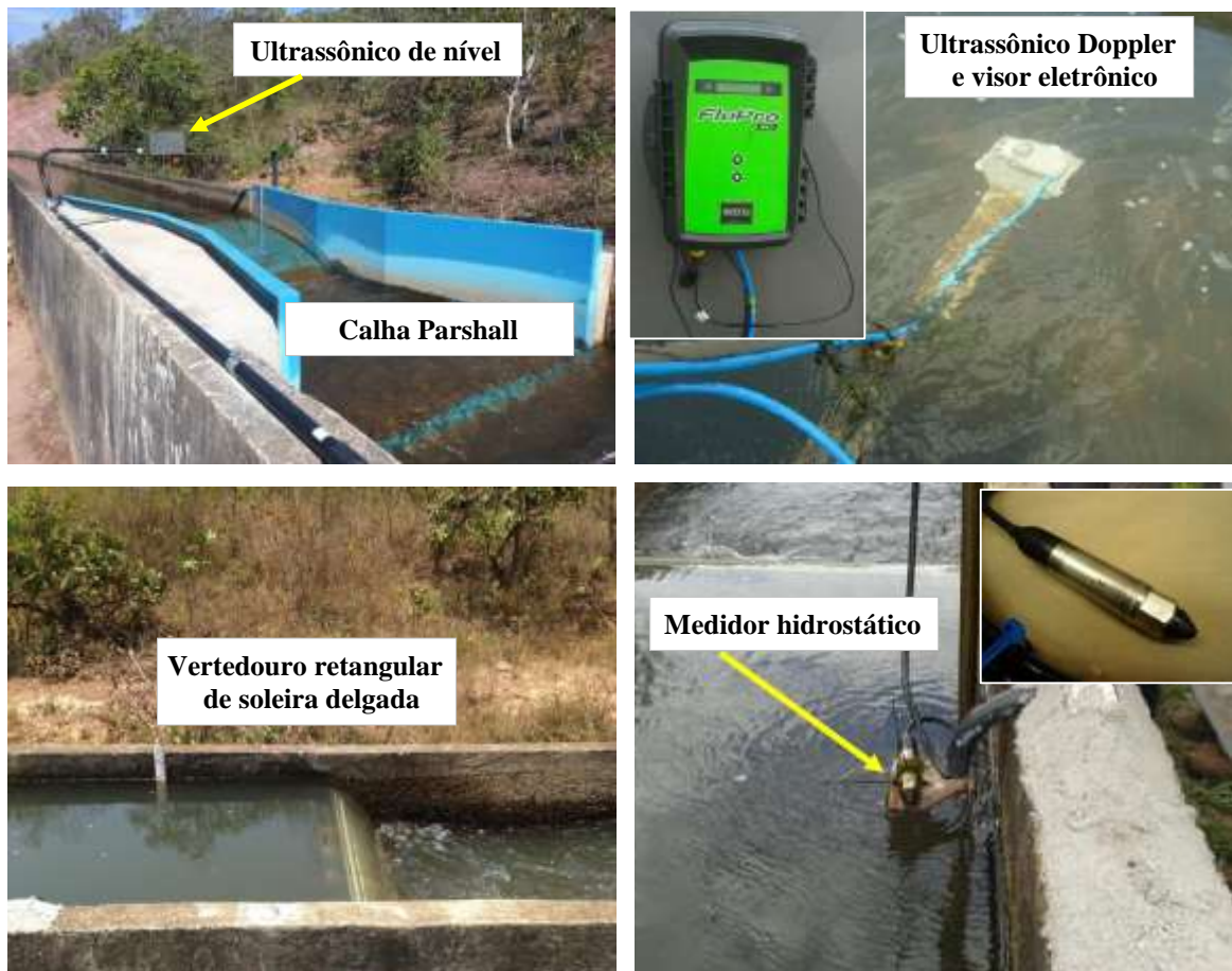
Figura C.7 – Estação 5: Canal de Irrigação Santos Dumont: equipamentos instalados
