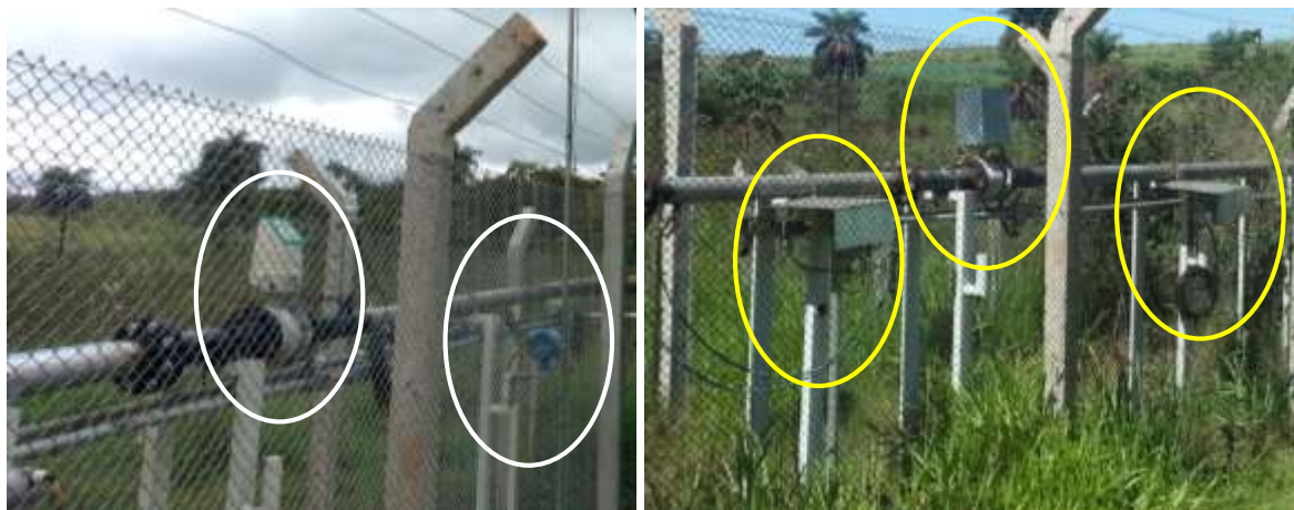
Figura C.21 – Estação 2 – Areal: equipamentos sem proteção (esq. – contorno em branco) e com proteção de chapa de alumínio (dir. – contorno em amarelo)
