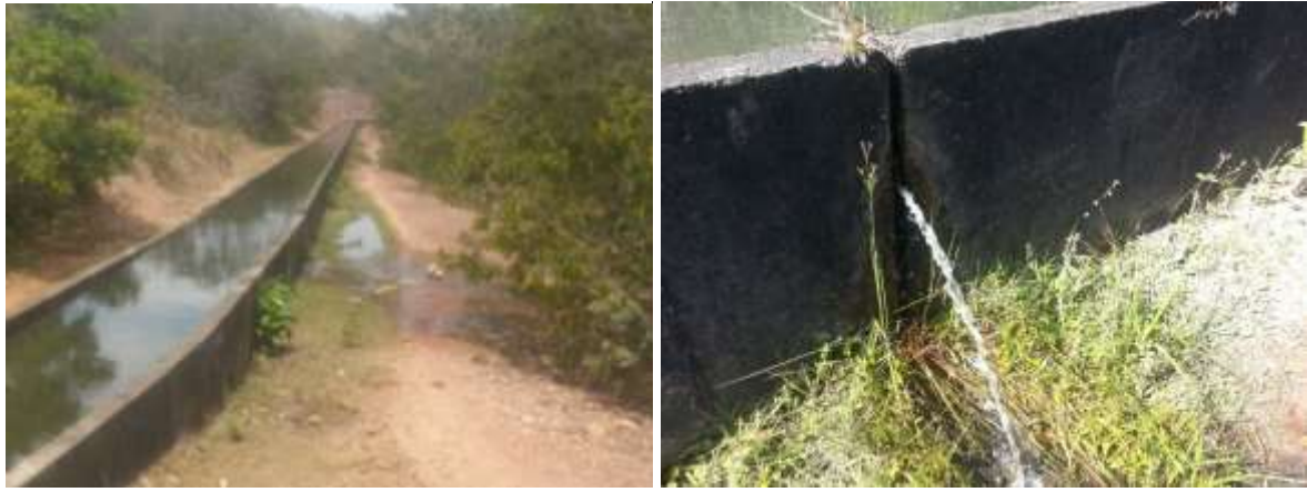
Figura C.35 – Vazamentos em juntas de dilatação entre a calha Parshall e o vertedouro
