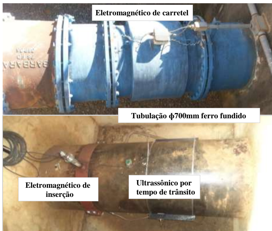
Figura C.6 – Estação 4 CAESB: tubulação de 700mm de diâmetro: acima, equipamento da CAESB já instalado; abaixo, dois equipamentos instalados pelo projeto piloto
