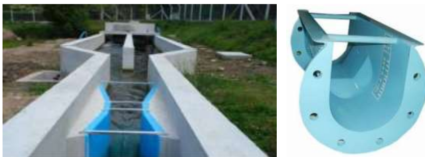
Figura 3.16 – Calha Parshall instalada (esq.) e calha Palmer-Bowlus (dir.) - Cortesia: Inccer
