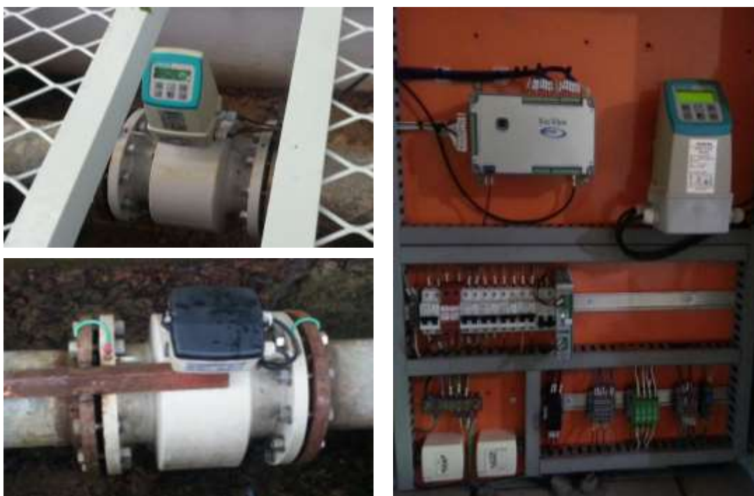
Figura C.17 – Estação 1 – Mazurek: Display do eletromagnético de carretel instalado na tubulação (acima, à esq.), retirado em ago/2014 para conserto (abaixo, à esq.) e reinstalado no painel (à direita)
