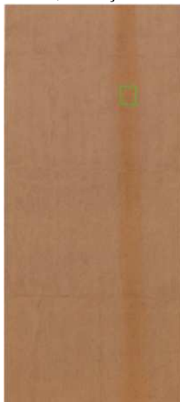
Figura 199 – Fachada com revestimento em textura e alteração cromática, e seleção da amostra
