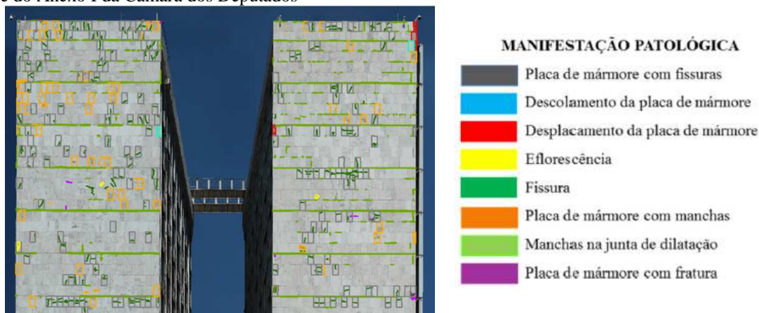
Figura 23 - Mapa dos danos em imagem panorâmica da etapa 1 da fachada Leste da torre do Anexo I da Câmara dos Deputados
