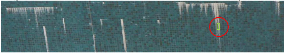
Figura 190 – Fachada com revestimento cerâmico e manchas de eflorescência, e seleção da amostra
