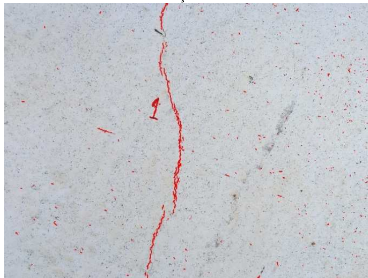
Figura 212 - Fissuras detectadas com operador Canny, Limiar máximo de 90%, limiar mínimo de 10% e \sigma = 3 , dilatação 5 \times 5
