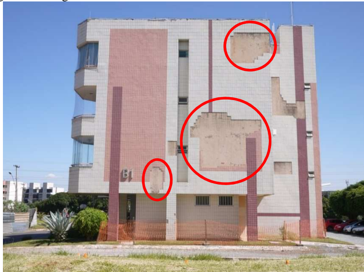
Figura 17 - Regiões da fachada com destacamento de revestimento cerâmico
