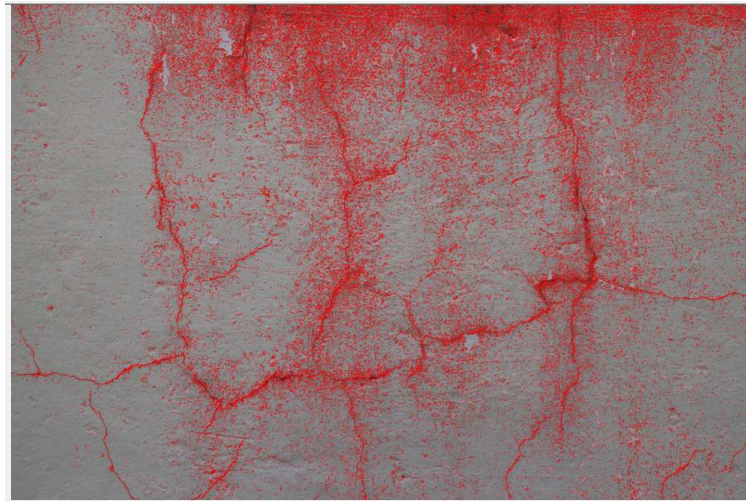
Figura 204 - Fissuras detectadas com operador Canny, limiar máximo de 20%, limiar mínimo de 15% e \sigma = 0,5
