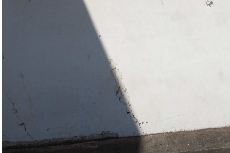
Figura 152 – Fotografia da fachada do museu com a formação de sombra sobre as fissuras
