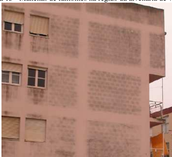
Figura 13 - Manchas de fantômes na região da alvenaria de vedação
