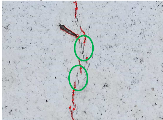
Figura 211 - Fissuras não detectadas
