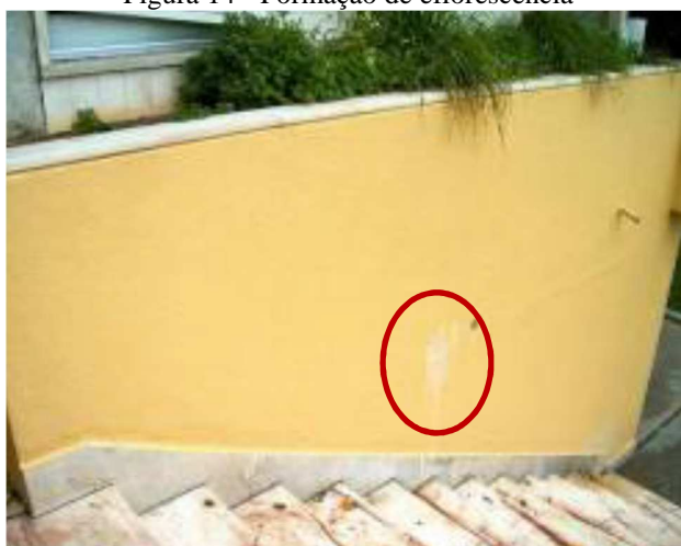
Figura 14 - Formação de eflorescência
