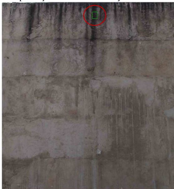
Figura 186– Elemento de vedação de fachada com a presença de manchas e a seleção da amostra
