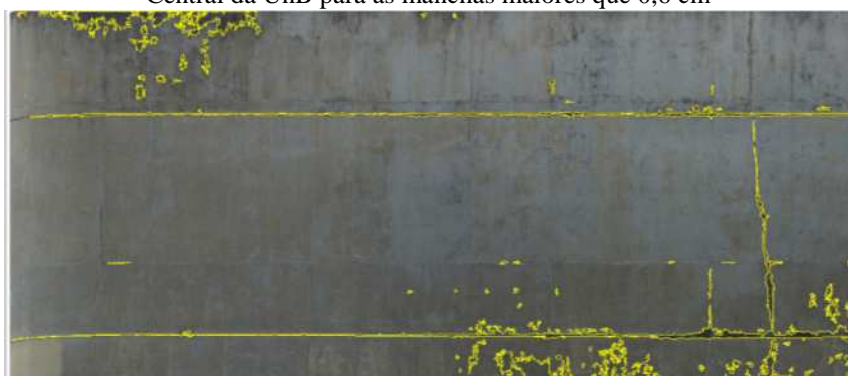
Figura 71 - (a) Mapa de danos da fachada da Biblioteca Central da UnB para as manchas maiores que 12 \text{ cm}^2 ; (b) Mapa de danos da fachada da Biblioteca Central da UnB para as manchas maiores que 0,6 \text{ cm}^2
