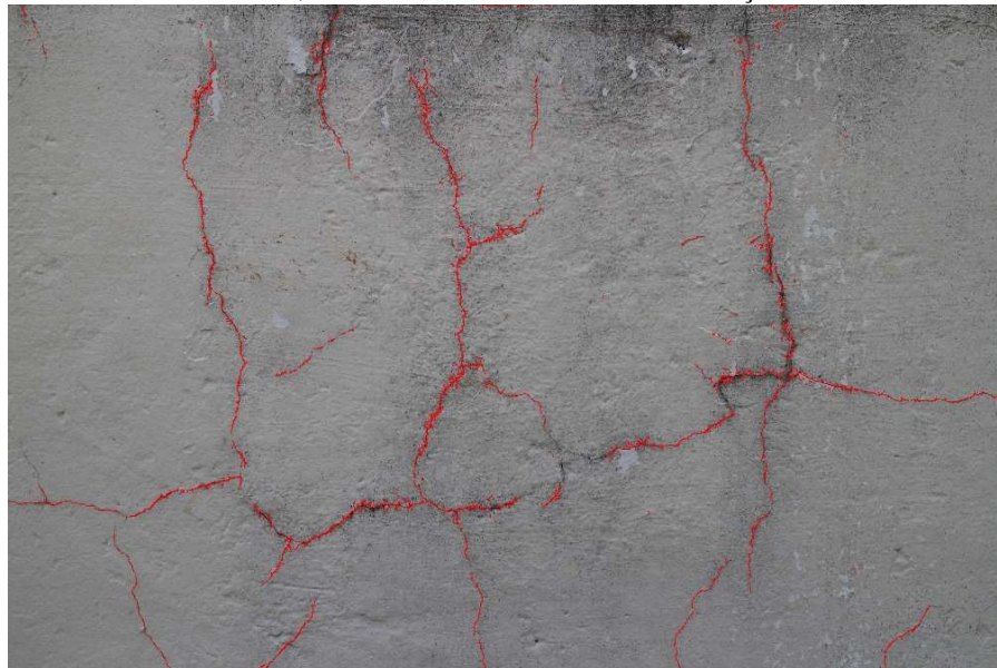
Figura 207 - Fissuras detectadas com operador Canny, sem dilatação, limiar máximo de 50%, limiar mínimo de 20% \sigma = 1 e remoção dos ruídos
