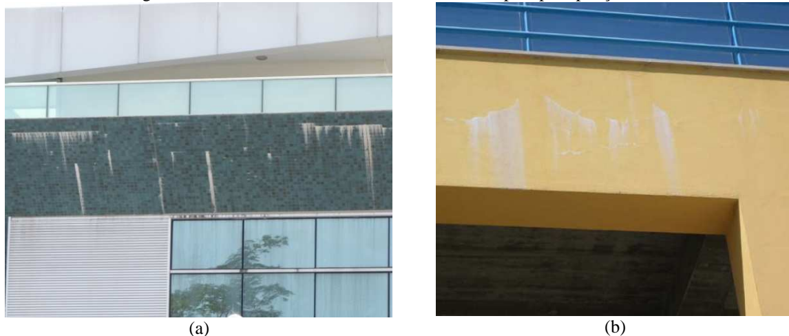
Figura 15 – Manchas de eflorescência ocasionadas pela precipitação de sais
