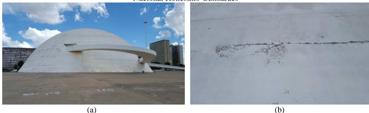
Figura 5 – (a) Museu Nacional Honestino Guimarães; (b) Fissuras observadas na fachada do Museu Nacional Honestino Guimarães
